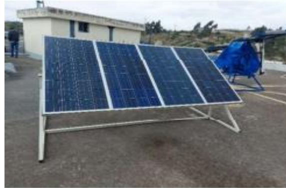
Fotografía C2: Planta fotovoltaica Fuente : Carrera de electromecánica
