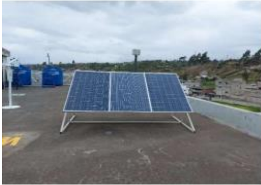
Fotografía C1: Paneles Fotovoltaicos Fuente : Carrera de electromecánica
