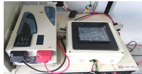
Fotografía D10: Pruebas de funcionamiento
