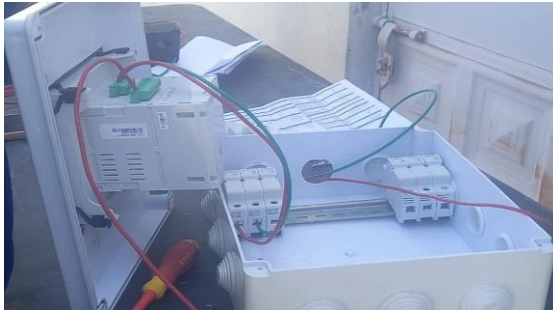
Fotografía D7: Conexión del analizador de red CVM-A1500.
