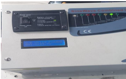
Fotografía C5: inversor DC/AC de 2KW Fuente: Carrera de electromecánica
