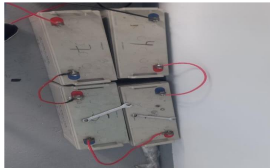
Fotografía C6: Banco baterías (GEL) Fuente: Carrera de electromecánica
