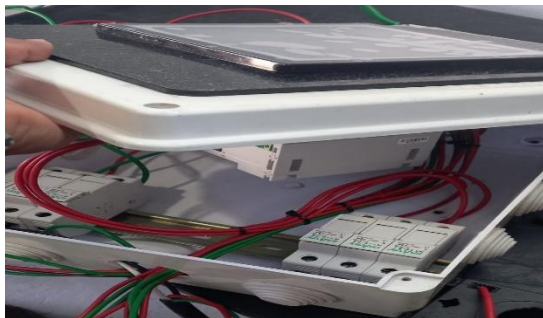
Fotografía D9: Implementación del analizador de red CVM-A1500 en una caja de protección.
