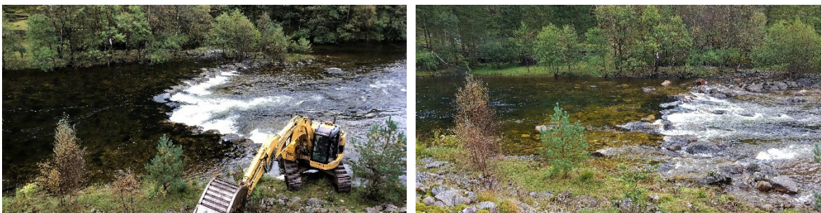
Figur 26. Terskeljusteringer der enkelte steiner fjernes fra terskelen (venstre: før, høyre etter justeringer).
