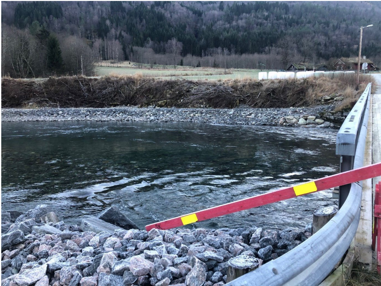
Figur 40: de tilførte masses ser ut som sprengstein og det kan se ut som elvebunnen ble løftet betydelig, noe som kan ha redusert avløpstverrsnittet. Bilde tatt av Knut Stauri.
