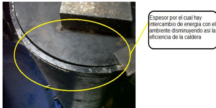
Figura 4. Deficiencias en la tapa inferior de la caldera.
