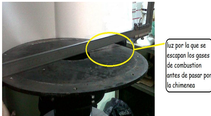
Figura 3. Deficiencias en la tapa superior de la caldera
