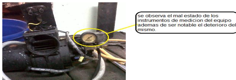
Figura 5. Estado actual del quemador.
