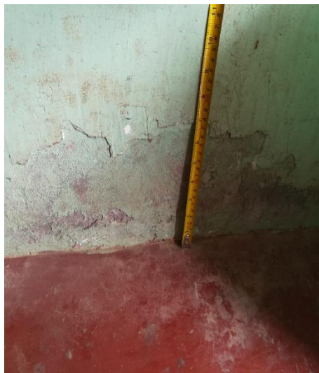
Figura N° 3. Registro de la patología en muro interior.
