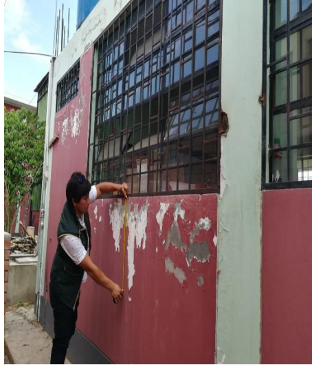
Figura N° 13. Registro de la patología de muro exterior.
