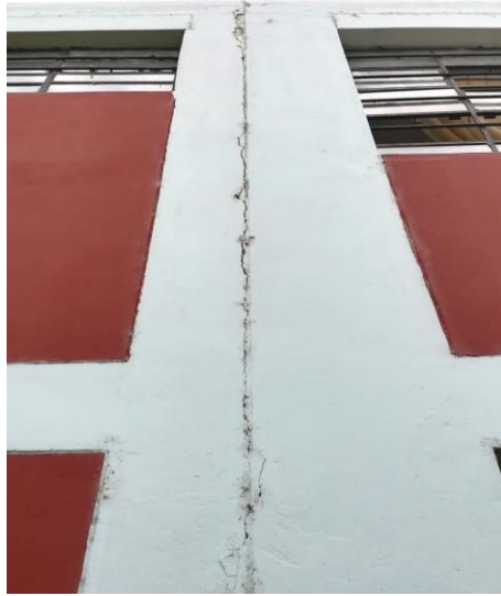
Figura N° 11. Registro de la patología en columna.
