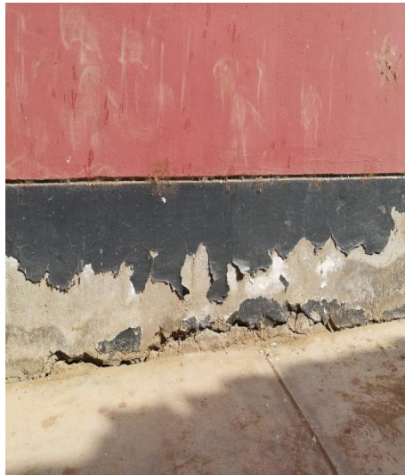
Figura N° 6. Registro de la patología en sobrecimiento.
