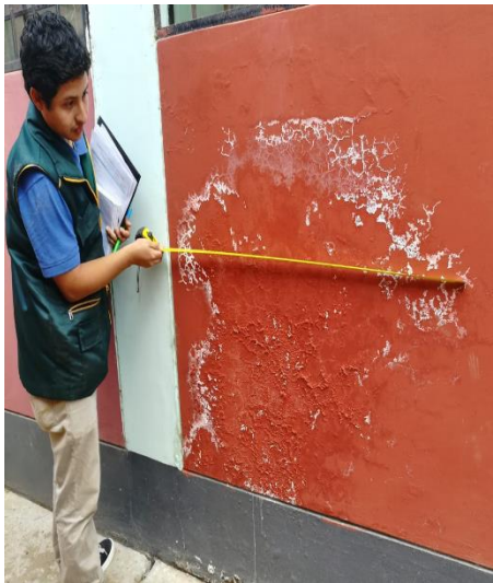
Figura N° 12. Registro de la patología de muro exterior.
