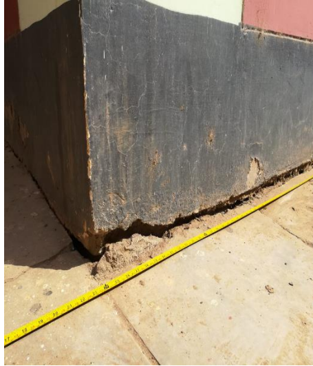
Figura N° 7. Registro de la patología en columna.
