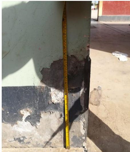
Figura N° 8. Registro de la patología en columna.
