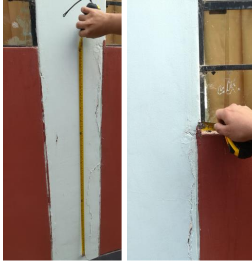
Figura N° 9. Registro de la patología en columna.
