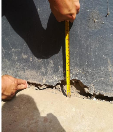
Figura N° 5. Registro de la patología en sobrecimiento.
