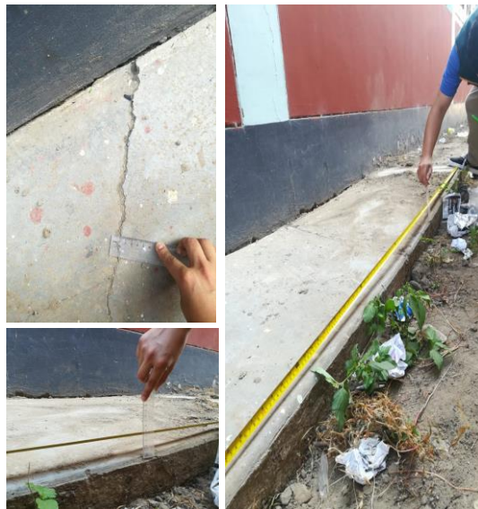
Figura N° 10. Registro de la patología en vereda.
