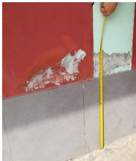
Figura N° 4. Registro de la patología en muro exterior y columna
