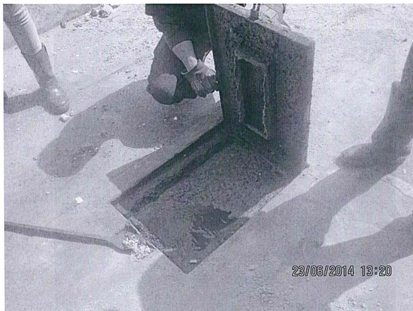
Fotografía N° 2: Ubicación del punto de Monitoreo establecido en la Planta Evitamiento de la Empresa Papelera Trupal S.A. (EF-02) para Efluentes.
