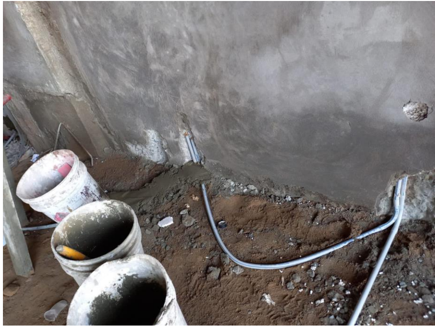
Figura N 44: Instalación de puntos de luz primer nivel. Fuente: Obra Vivienda Unifamiliar Villa el Salvador-enero 2022
