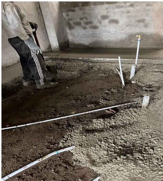
Figura N 45: Vaciado del falso piso del primer nivel Fuente: Obra Vivienda Unifamiliar Villa el Salvador-enero 2022
