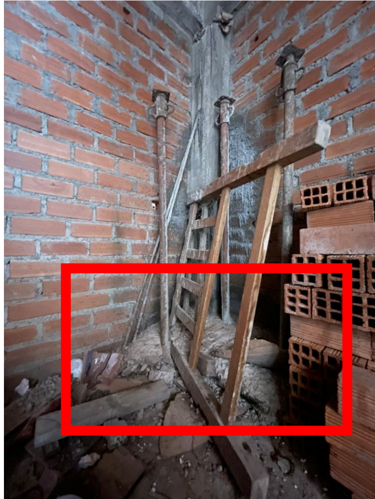
Figura N 95: Exceso de Concreto por realizar el encofrado sin refuerzo en la parte laterales de la columna.
