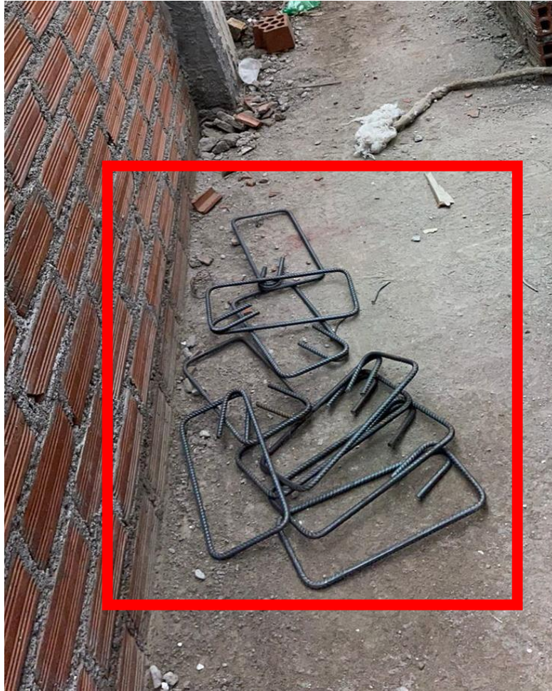
Figura N 94: Estribos realizados por encima de lo requerido Fuente: Supervisión de Obra Proyecto Vivienda Unifamiliar-SACRE INVERSIONES S.A.C-septiembre 2022
