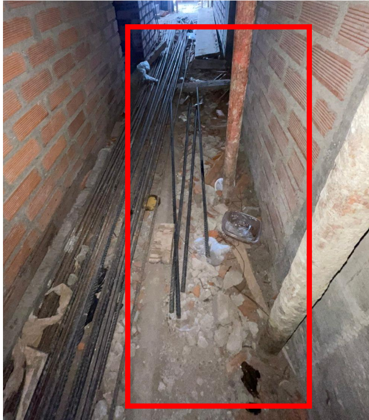
Figura N 96: Pasadizo contaminado por recipientes de comida
