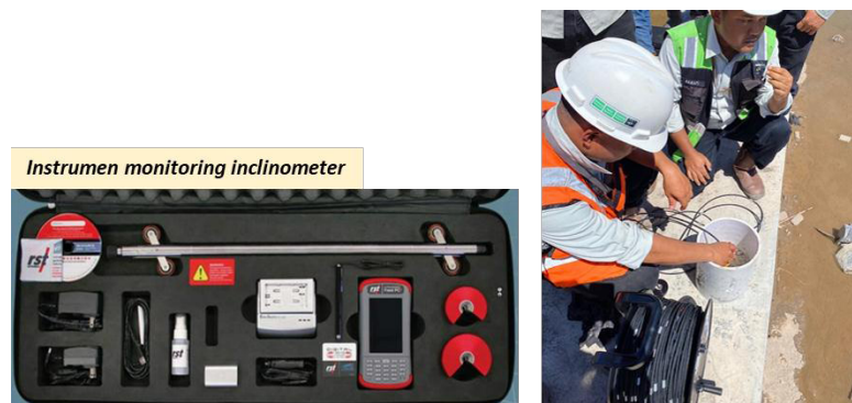
Gambar 9. Monitoring Pergerakan Bored pile menggunakan Inclinometer (Sumber: pengolahan data penulis)
