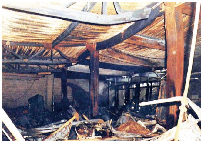
図 1.1 火災でたわんでも崩落しない鋼構造床架構 (Broadgate Phase 8, London, 2006)
