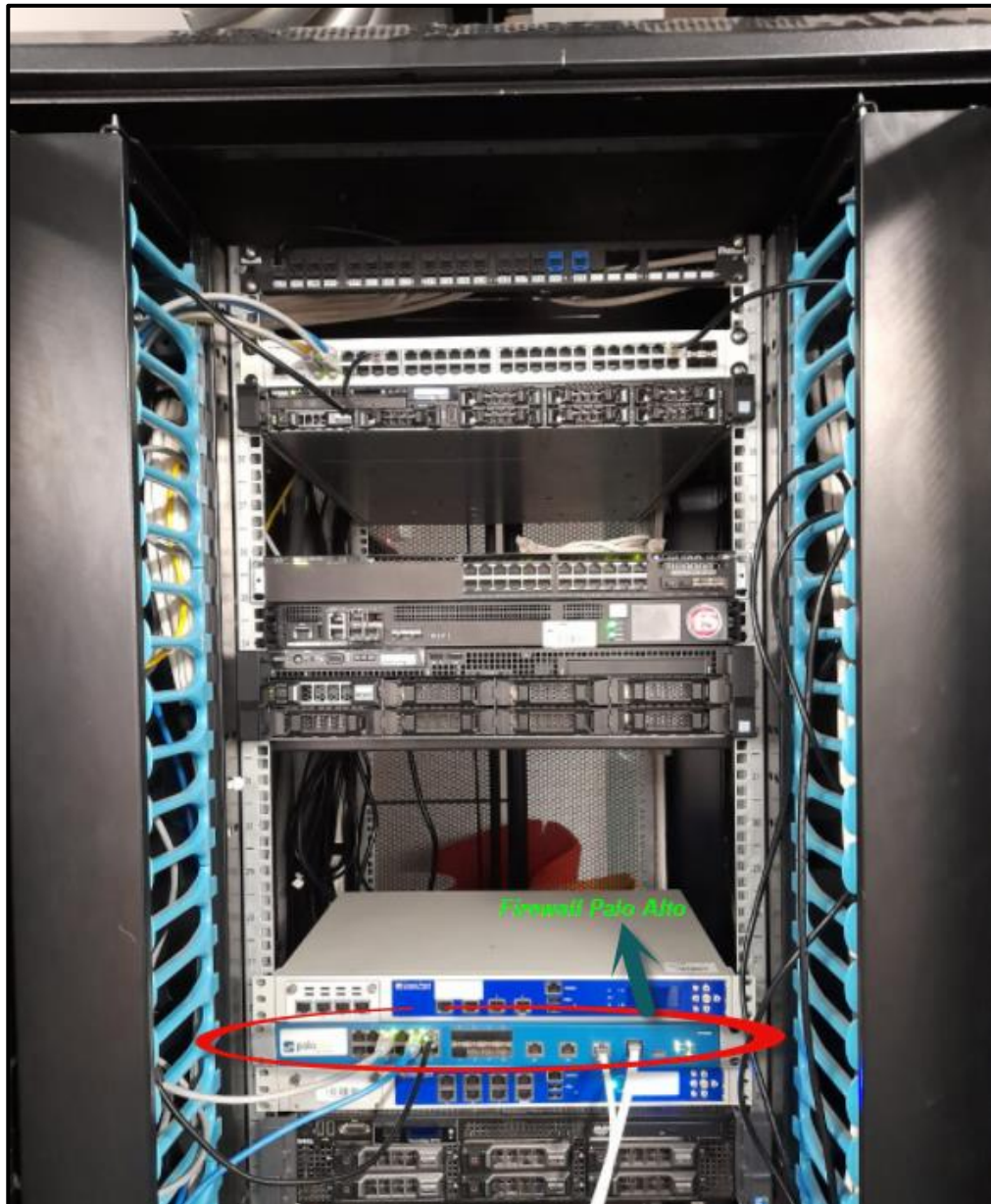
Figura 162. Equipo Firewall Palo Alto 3050 en instalado, implementado y en operación
