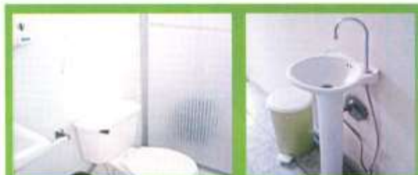
Instalaciones sanitarias de una planta procesadora
