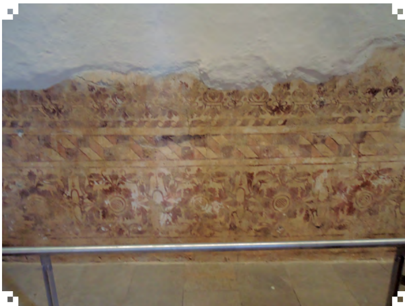
Imagen 63. Restos de pintura mural en el Colegio de Santa Catalina.
