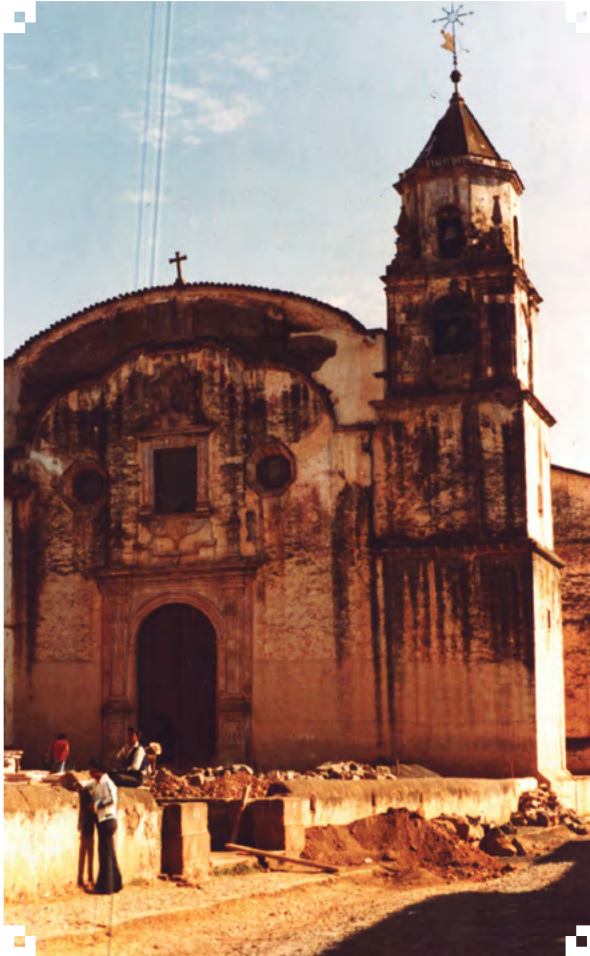
Imagen 23. Templo de San Ignacio de Loyola durante su restauración. Se distingue la diferencia de estructuras original y la bóveda de madera sobrepuesta y el deterioro del edificio.
