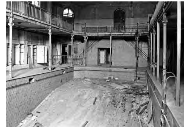
Das Nordbad in desaströsem Zustand, 1991
