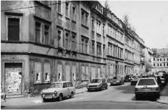
Dringender Handlungsbedarf zu Beginn des Sanierungsprozesses in der Talstraße, 1991
