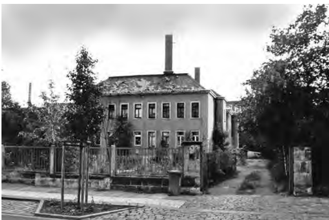
Zwei ruinöse Gebäude auf der Leisniger Straße 70
