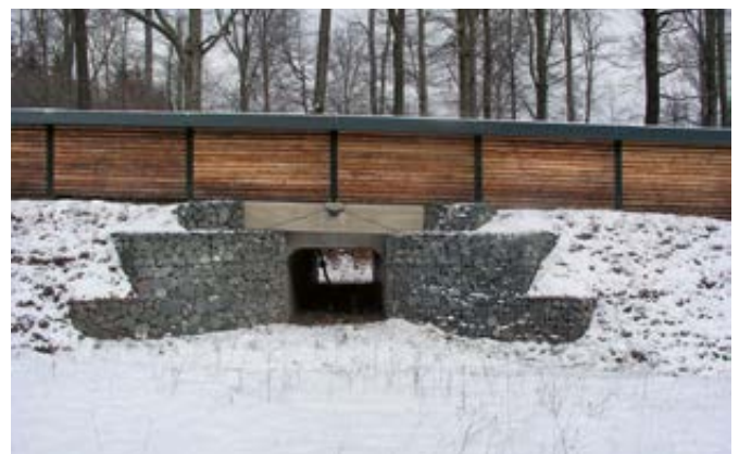
Abb. 42: Wildkatzenunterführung (1,90 x 1,50 m) ausgestattet mit Schall- und Blendschutz sowie einem Wildkatzenzaun an der B242 im Harz (Foto: M. Götz & S. Jerosch)
