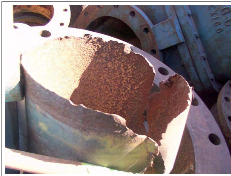
Fig. 17.1 Efectos de agua corrosiva
