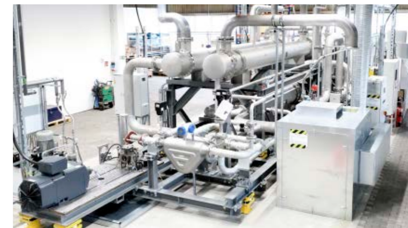
Dieser Prototyp einer speziellen Hochtemperatur-Wärmepumpe namens CoBra steht am DLR-Institut für CO 2 -arme Industrieprozesse in Cottbus. Die Anlage kann Wärme und Kälte für Industrieprozesse im Demonstrationsmaßstab bereitstellen.
