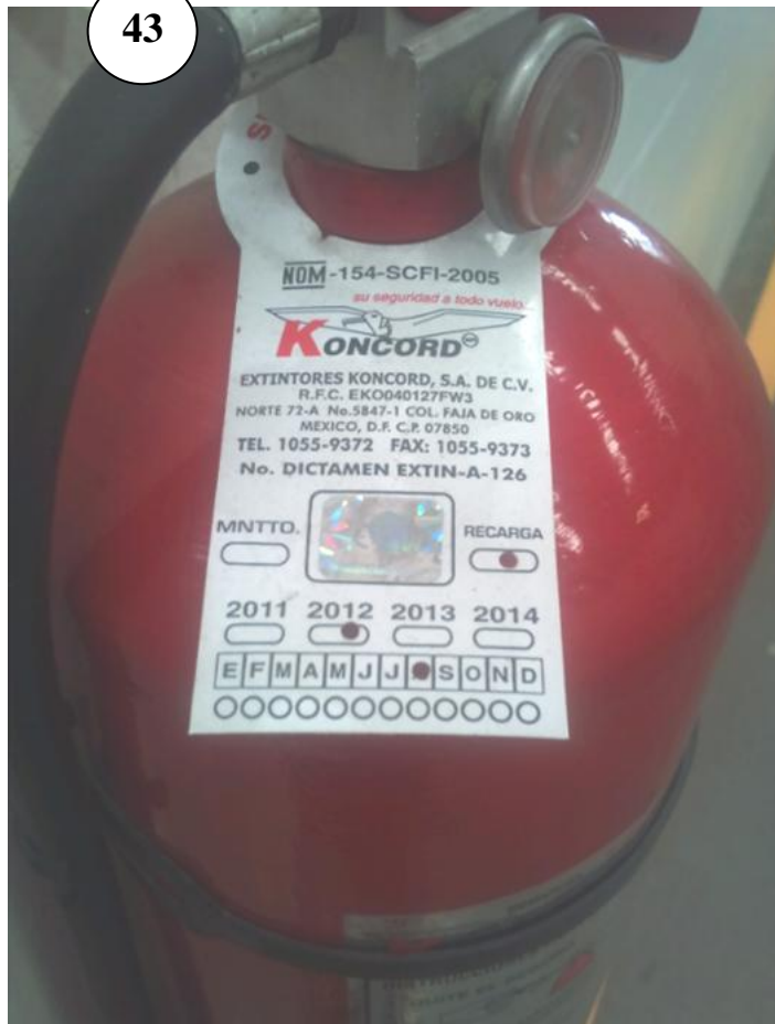
Fig. 19 Etiqueta de llenado en extintor
