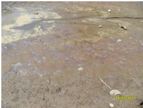
Figura 8. Suelo con coloración ocre en el ingreso de la presa Tecualoyan.
