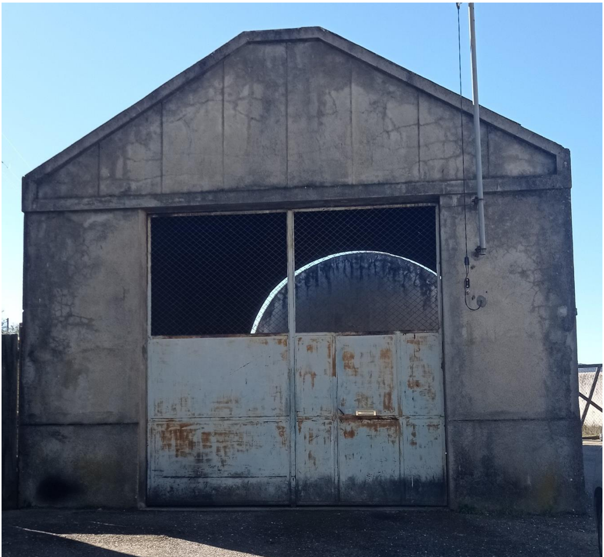
Figura 47 - Garagem de Peraboa
