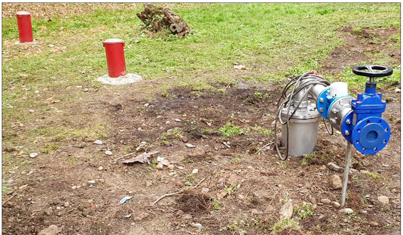
FIGURA 10 – Il pozzo con pompa sommersa capace di pompare fino a 15 l/s e i due piezometri realizzati precedentemente.
