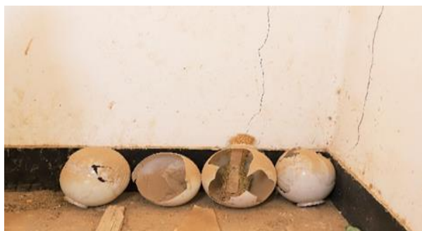
(صورة ٢٠) توضح الشقوق في الجدران. أيضا تراكم الانساختات علي الأرضية الزجاج المحطم وهو مسجل في الآثار. والشروخ المنتشرة علي الجدران الداخلية للقبة.
