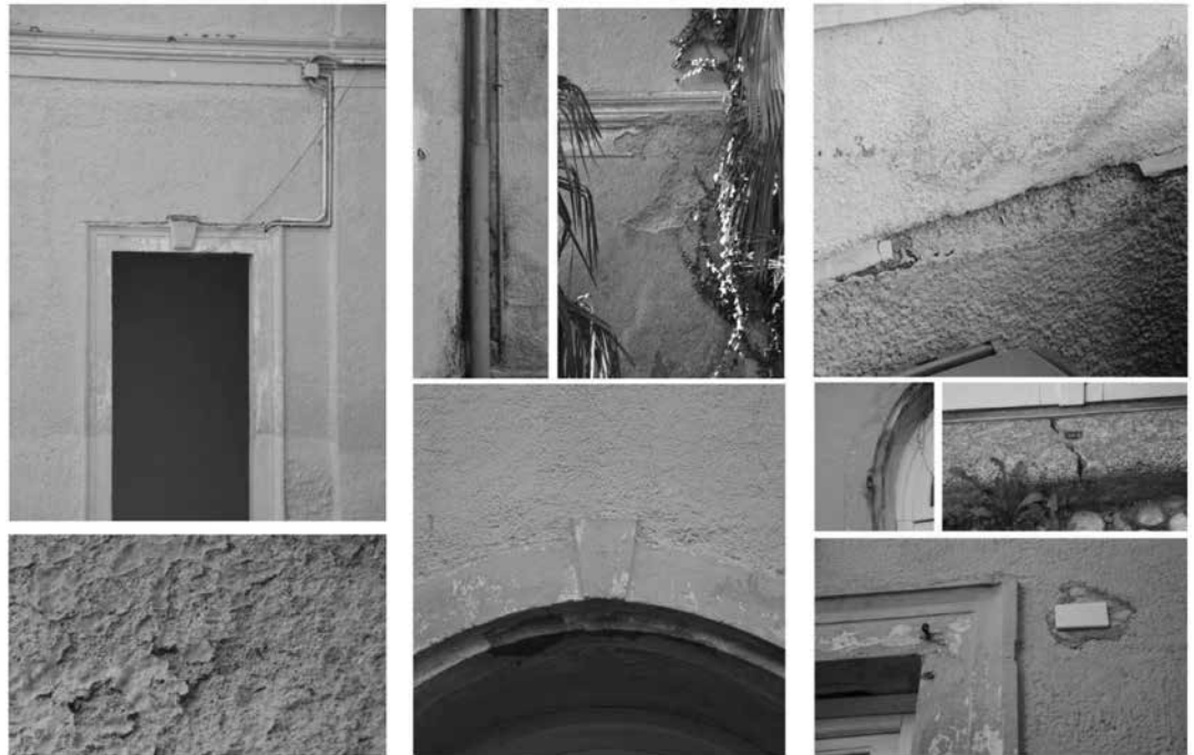
Fig. 24 - Fig. 25 -. Fig. 26: Gruppo 5, Rilievo fotografico del degrado.
