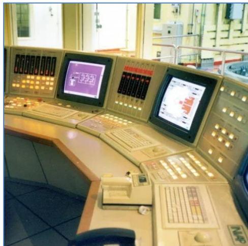
Figura 10. Sala de Control del reactor ETRR-2. Fuente: INVAP, Reactor ETRR-2 de Egipto, 2015.
