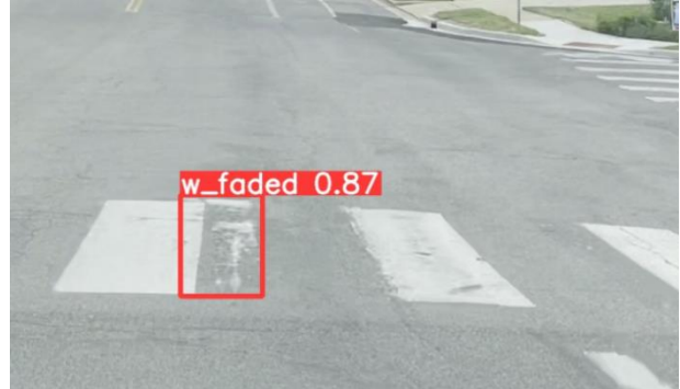
(d) Faded white crosswalk marking
