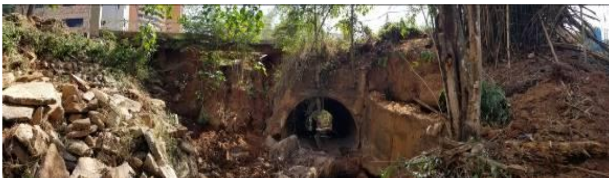
Figura 2.- Vista panorámica desde aguas abajo de la descarga de la alcantarilla. Obsérvese la erosión en los taludes y las fracturas del cabezal de salida, así como el asentamiento de la aleta izquierda (a color). Fuente: Autores.
