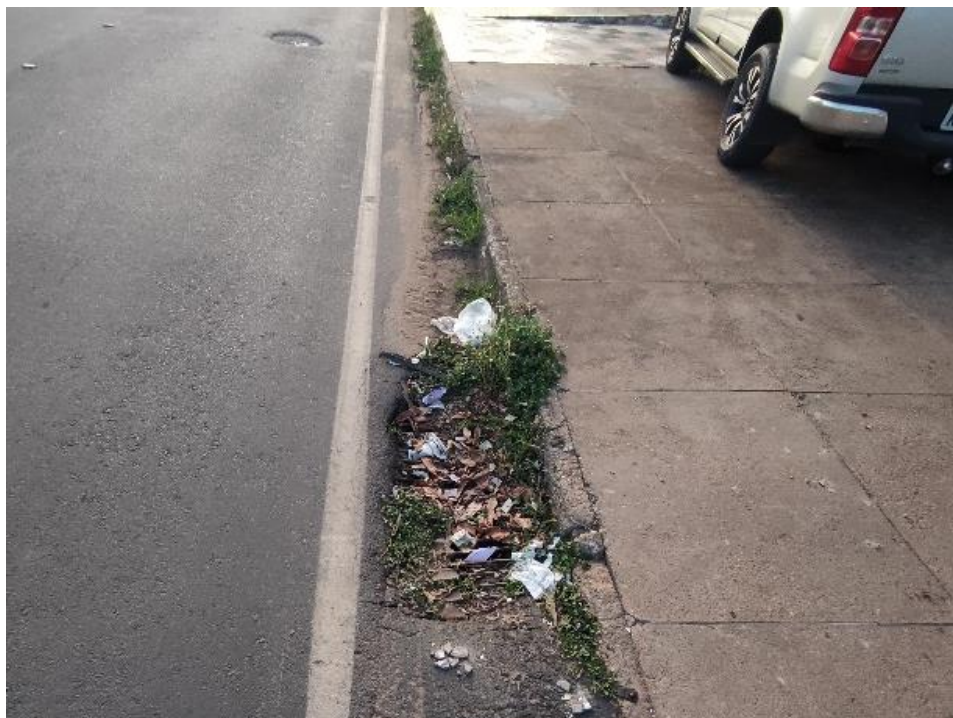
Figura 4.- Boca-de-lobo e sarjeta obstruída.
