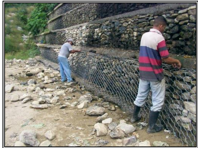
Figura 8.- Vista de las reparaciones realizadas a las cestas y la protección de concreto del paramento aguas abajo de la presa. (Octubre 2006).
