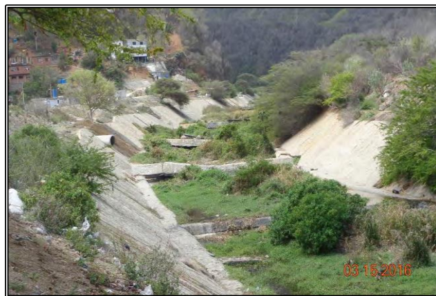
Figura 27.- Vista general de la canalización del Río Camuri Grande en donde se observa las afectaciones de las traviesas, así como la falta de mantenimiento del cauce. (Septiembre 2016).
