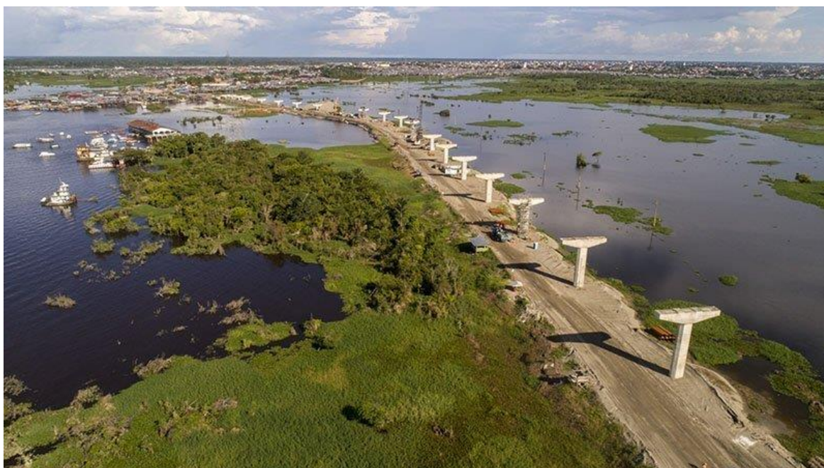
Figura 1 - Vista área da plataforma construtiva que facilitou a construção das fundações sobre o rio Nanay
