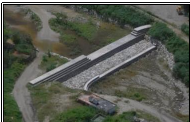
Figura 19.- Vista de la Presa N° 1.- Obsérvese que la presa está concluida, pero no se colocó el enrocado al pie del contradique para su protección a la socavación, así como tampoco se había construido la canalización, (Abril 2008).
