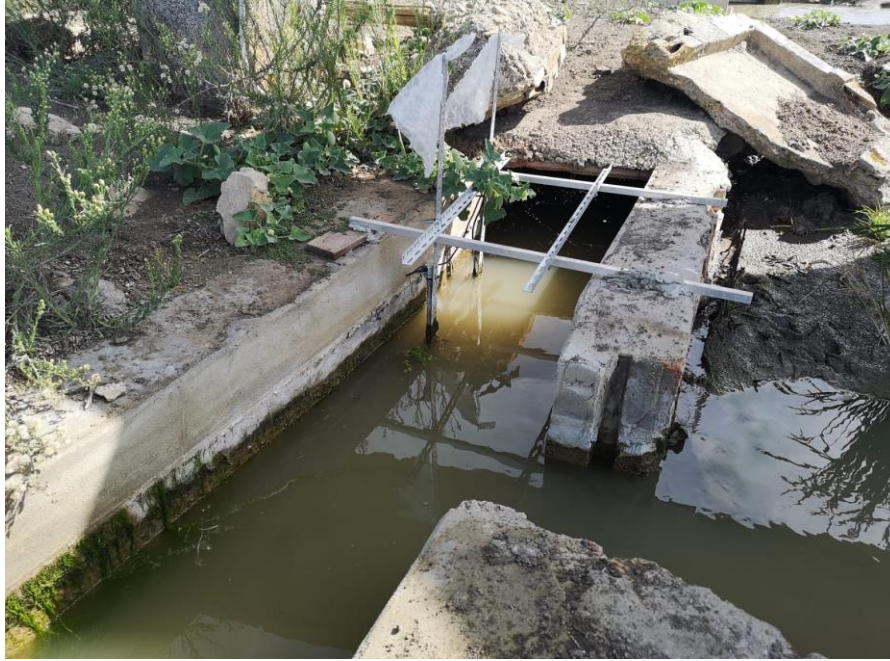
Figura 3.- Sensores instalados en la entrada del canal.
