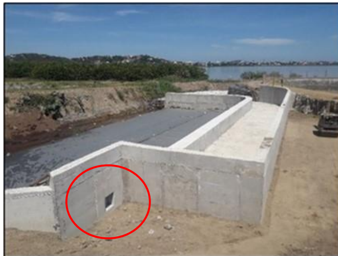
Foto 2.- Vertedouro do Rio Arrozal na fase inicial de execução. Destaque para orifício que irá direcionar as águas do Rio à Bacia de Sedimentação.
