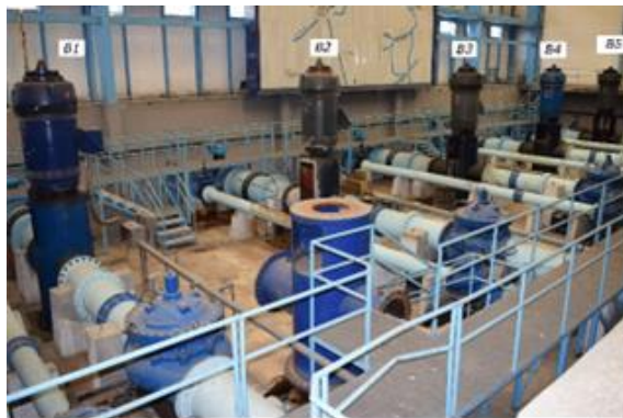
Figura 3.- Cárcamo de succión y bombas del Rebompeo Estrella
