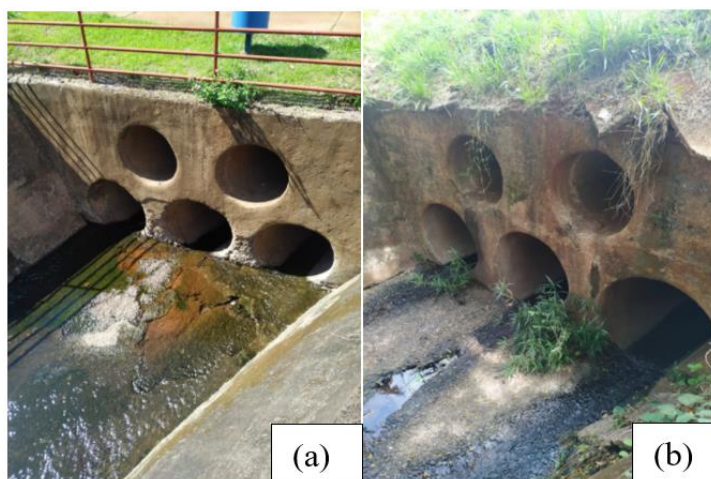
Figura 17.- Manifestações de erosão no Bueiro hidráulico (a) montante (b) jusante
