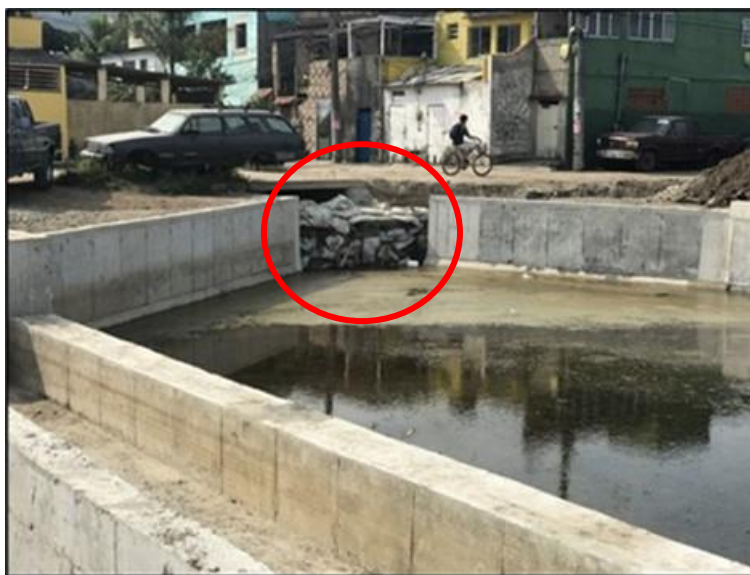
Foto 3.- Vertedouro do Rio Arrozal em fase de finalização. Destaque para o local de conexão com o corpo hídrico, ainda com a passagem fechada.
