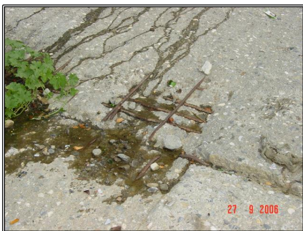
Figura 23.- Vista de la abrasión del concreto por efecto de flujo de lodos y piedras en la Canalización de la Quebrada Guanape. Obsérvese el acero de refuerzo al descubierto. (Septiembre 2006).
