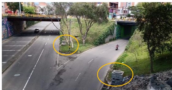
Figura 6.- Cámara de captación en intercambio vial a desnivel Bulerías. Fuente: fotografía del autor.
