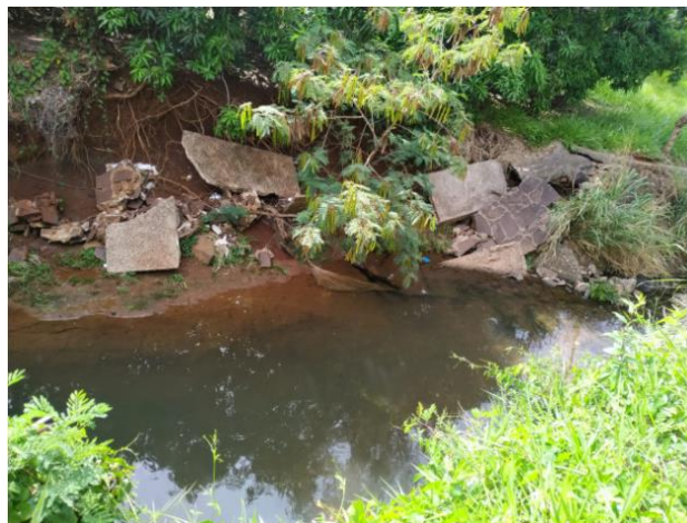
Figura 18.- Erosão de terra e arraste a jusante do canal
