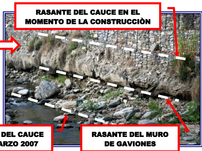
Figura 18.- Vista en detalle de la Figura 60.-, en donde se identifica el nivel de rasante del cauce en el momento de la construcción, la rasante del muro de gaviones construido y la rasante del cauce para marzo 2007.
