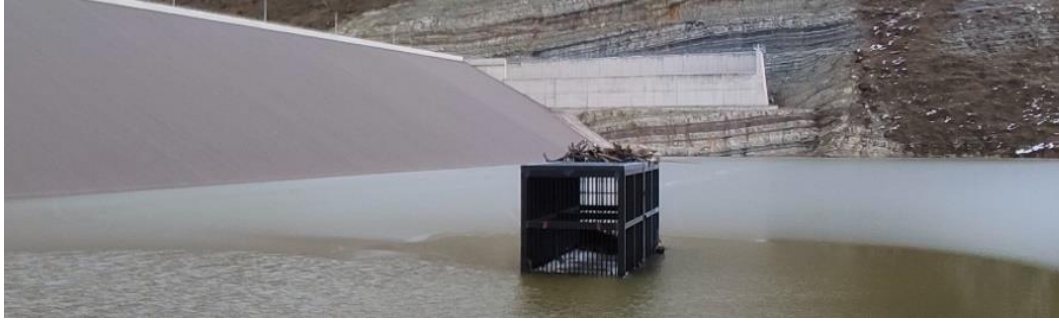
Figura 65.- Rejas de retención de arrastres en la obra de toma del desagüe de fondo.
