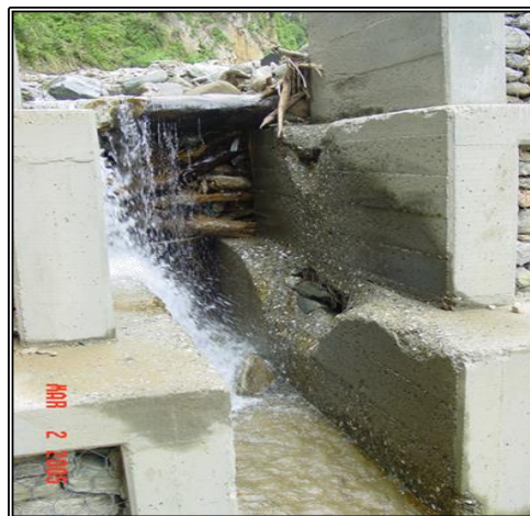
Figura 24.- Presa Abierta en Quebrada El Cojo, Estado Vargas, Venezuela. Los dientes de la presa fueron recubiertos con concreto, pero la abrasión producida por el Evento de febrero de 2005 dejó huellas indelebles.
