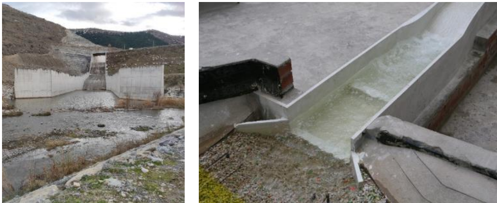
Figura 63.- Aliviadero de superficie. Vista del cuenco de amortiguamiento en prototipo y modelo físico.
