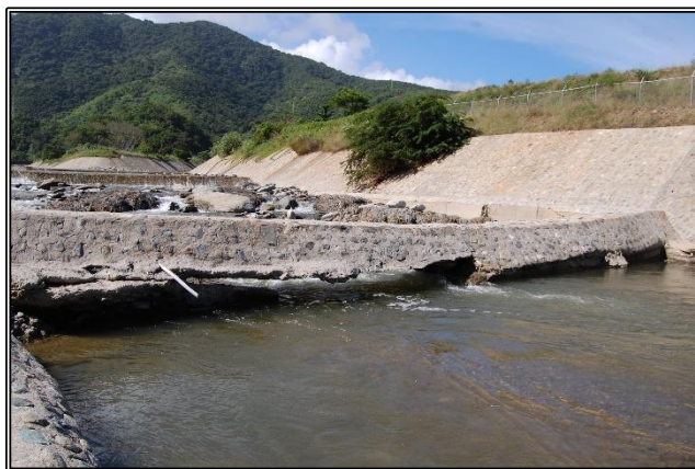
Figura 26.- Vista de una de las traviesas del Río Camuri Grande en donde aprecia la socavación al pie de la misma y su afectación. (Diciembre 2010).
