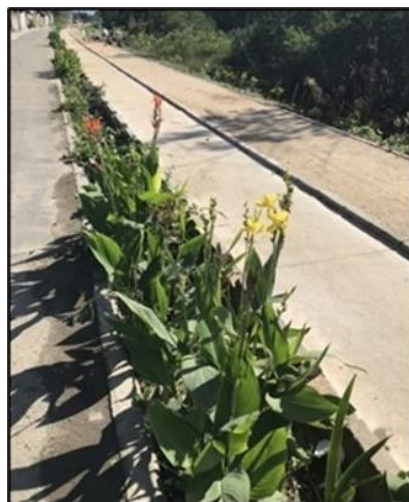
Foto 6.- Biovaletas do POP já finalizadas Fonte: as autoras
