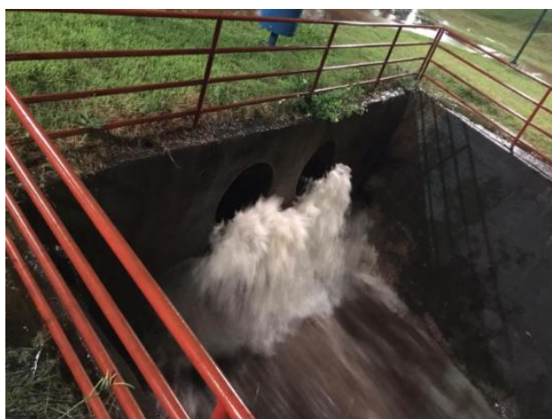
Figura 14.- Registro do bueiro em funcionamento
