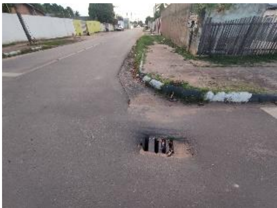
Figura 5.- Boca-de-lobo danificada e em local impróprio.
