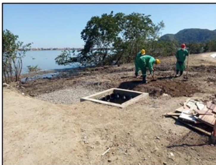
Foto 5.- Execução de caixas de passagem entre os Jardins Filtrantes Fonte: as autoras.
