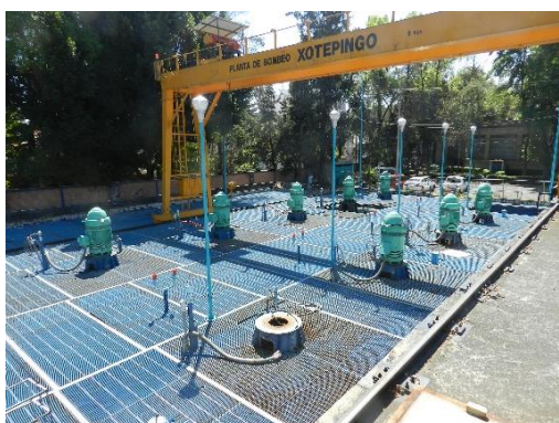
Figura 1.- Cárcamo de succión y bombas de PB Xotepingo
