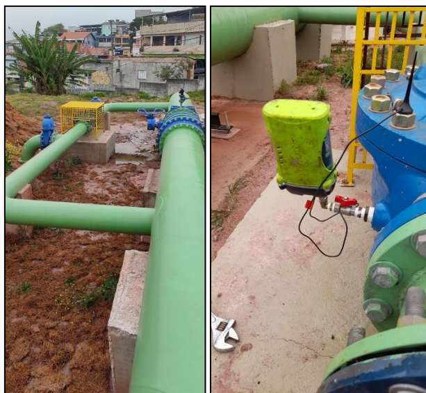
Figura 100 - Local de Instalação no barrilete de 300mm que abastece o TAU
