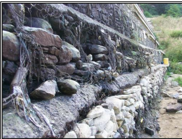
Figura 7.- Vista de los deterioros en el paramento aguas abajo de la presa. (Marzo 2005).
