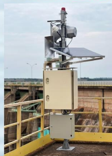
ESTAÇÃO DE SIRENES
