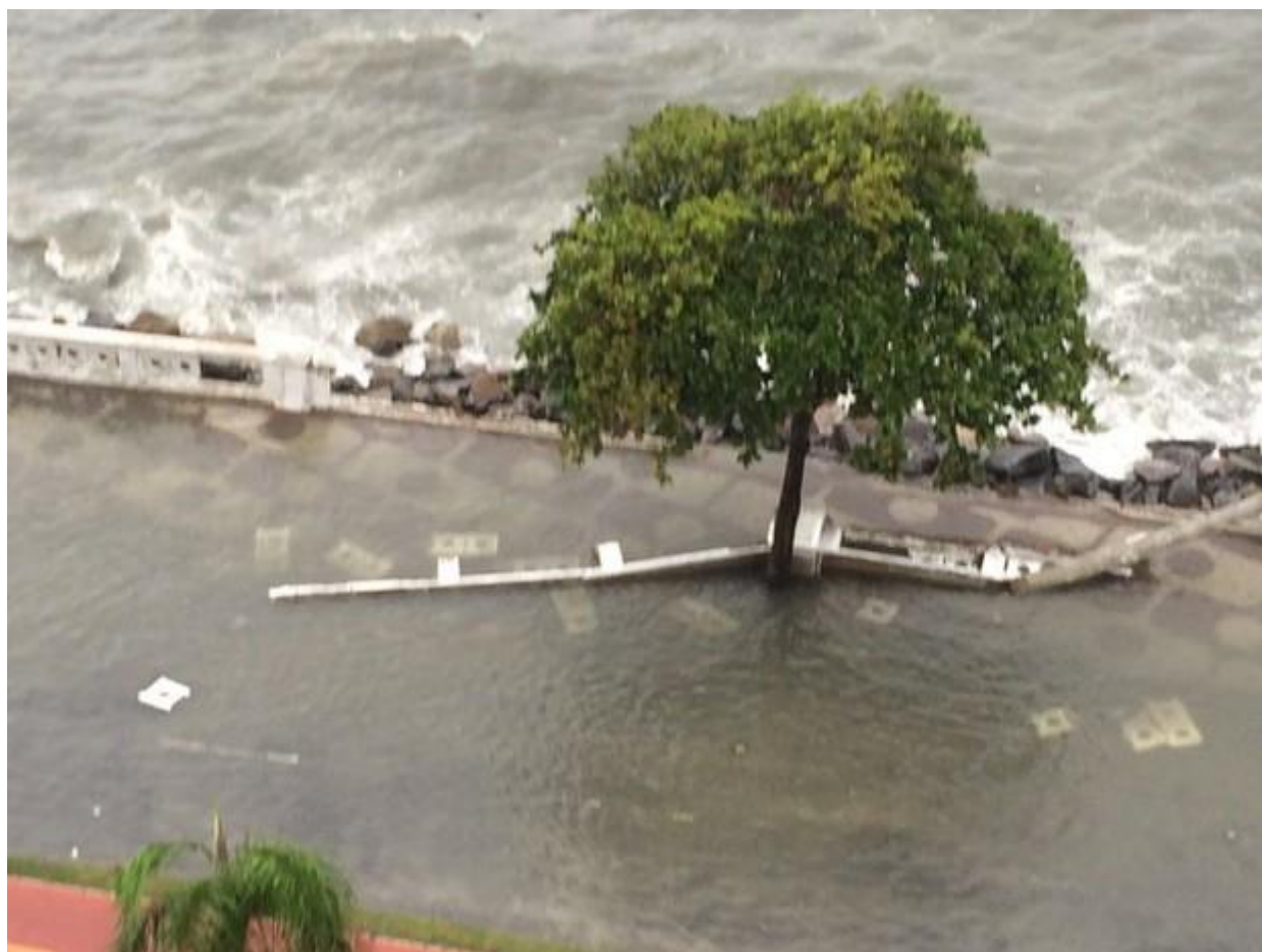
Figura 2.- Mureta na região da Ponta da Praia destruída após forte ressaca em 2016. Fonte: G1 (2016)
