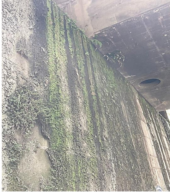
Nota. aletas concreto contaminado. Fuente: propia
