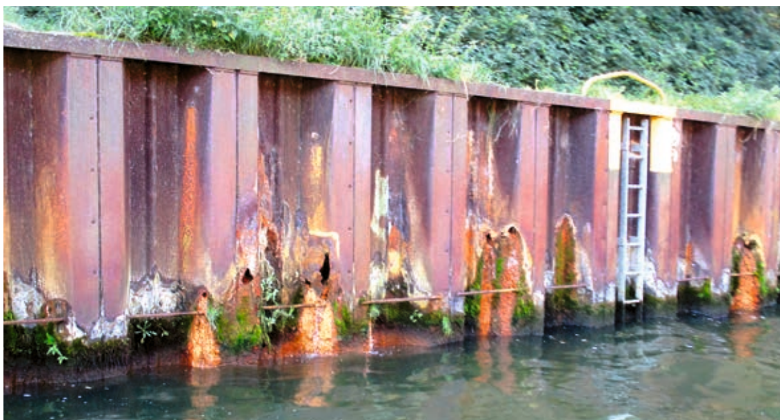
Abbildung 4: Durchrostung einer Spundwand am Rhein-Herne-Kanal durch mikrobiell induzierte Korrosion (Quelle: BAW)
