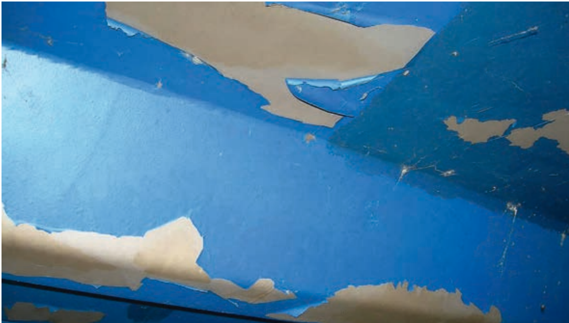
Abbildung 33: Schadensfall an einer Straßenbrücke am Datteln-Hamm-Kanal mit abgängiger blauer Polyurethandekbeschichtung
