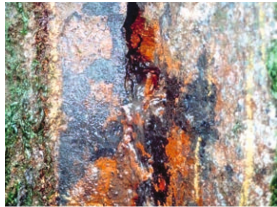
Abbildung 5: Korrosion durch Sulfat reduzierende Bakterien mit Ablagerung von schwarzem Eisensulfid (Quelle: BAW)
