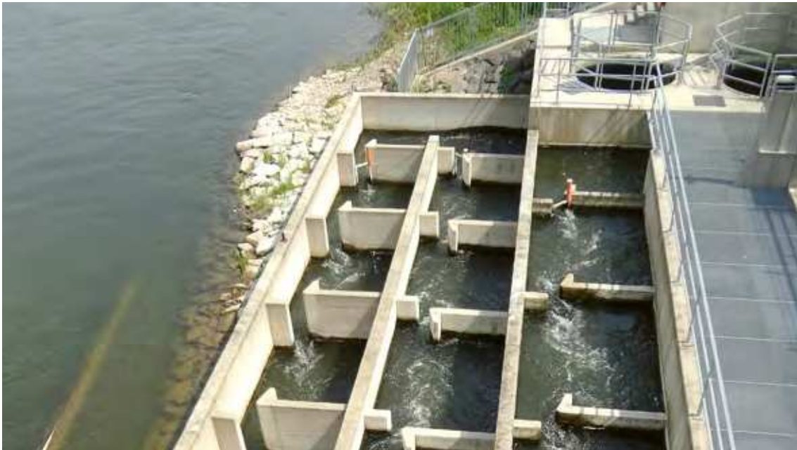
Abbildung 114: FAA in Schlitzpass-Bauweise an der Stauanlage Koblenz/Mosel.
