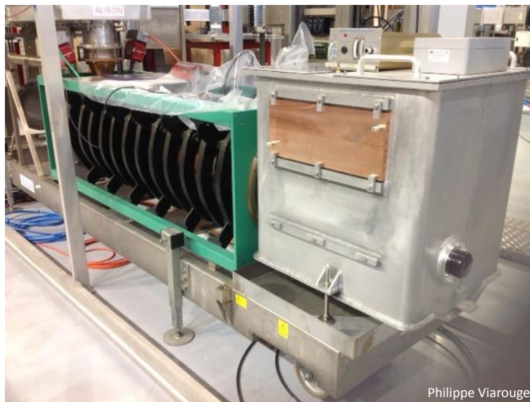
FIGURE 1.5 – Klystron de 2.8 MW du LINAC 4 au CERN.
