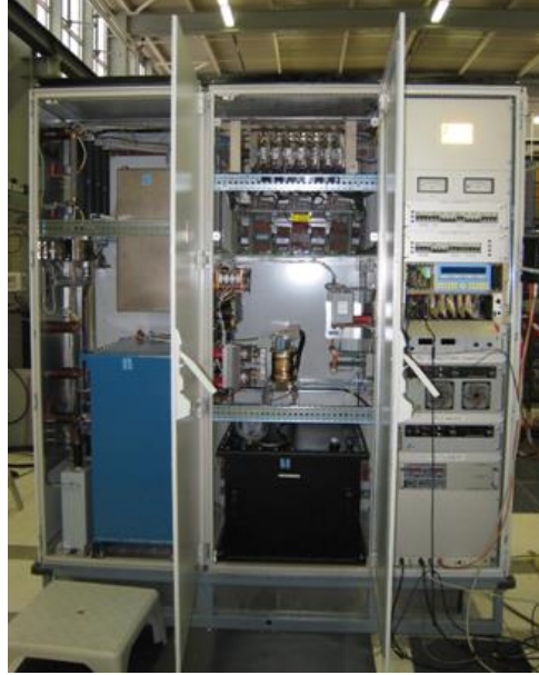
FIGURE 1.3 – Photo d’un modulateur à transformateur d’impulsion monolithique. Le transformateur d’impulsion se trouve dans la cuve bleue dans le rack de gauche. Extrait de [57].
