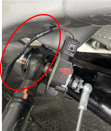
Figura 45 - Cablagem do sensor.
