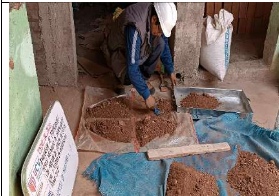
Imagen 46: Se cuartea el material C-1
