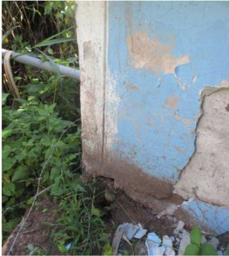
Vista: reservorio deteriorado
