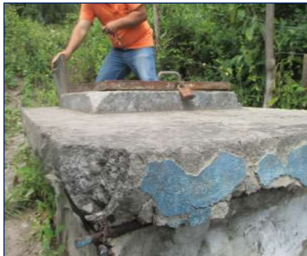
Figura 1. Estado actual de cámara rompe presión
