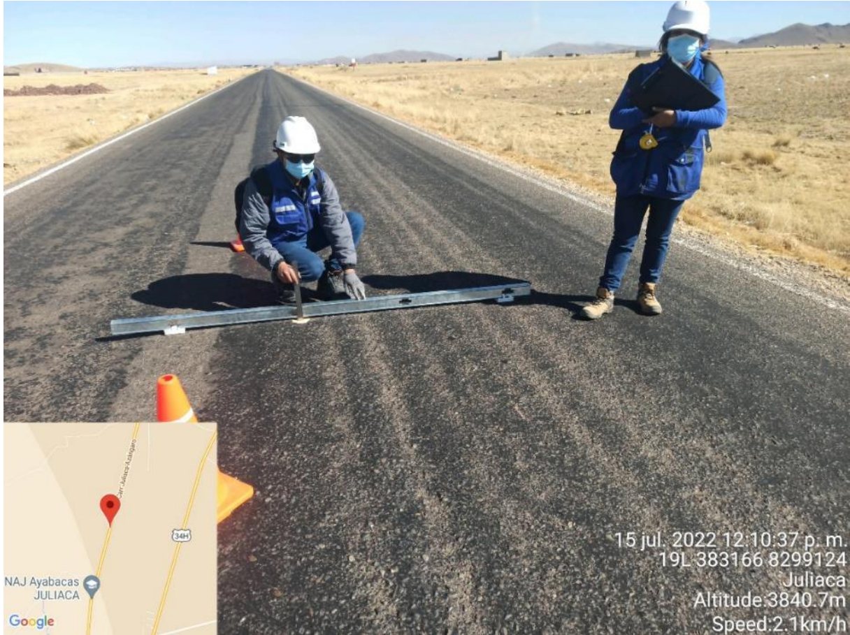
Figura N° 19: Representación gráfica de la falla de “DEFORMACIÓN POR DEFICIENCIA ESTRUCTURAL” Fuente: Elaboración nuestra
