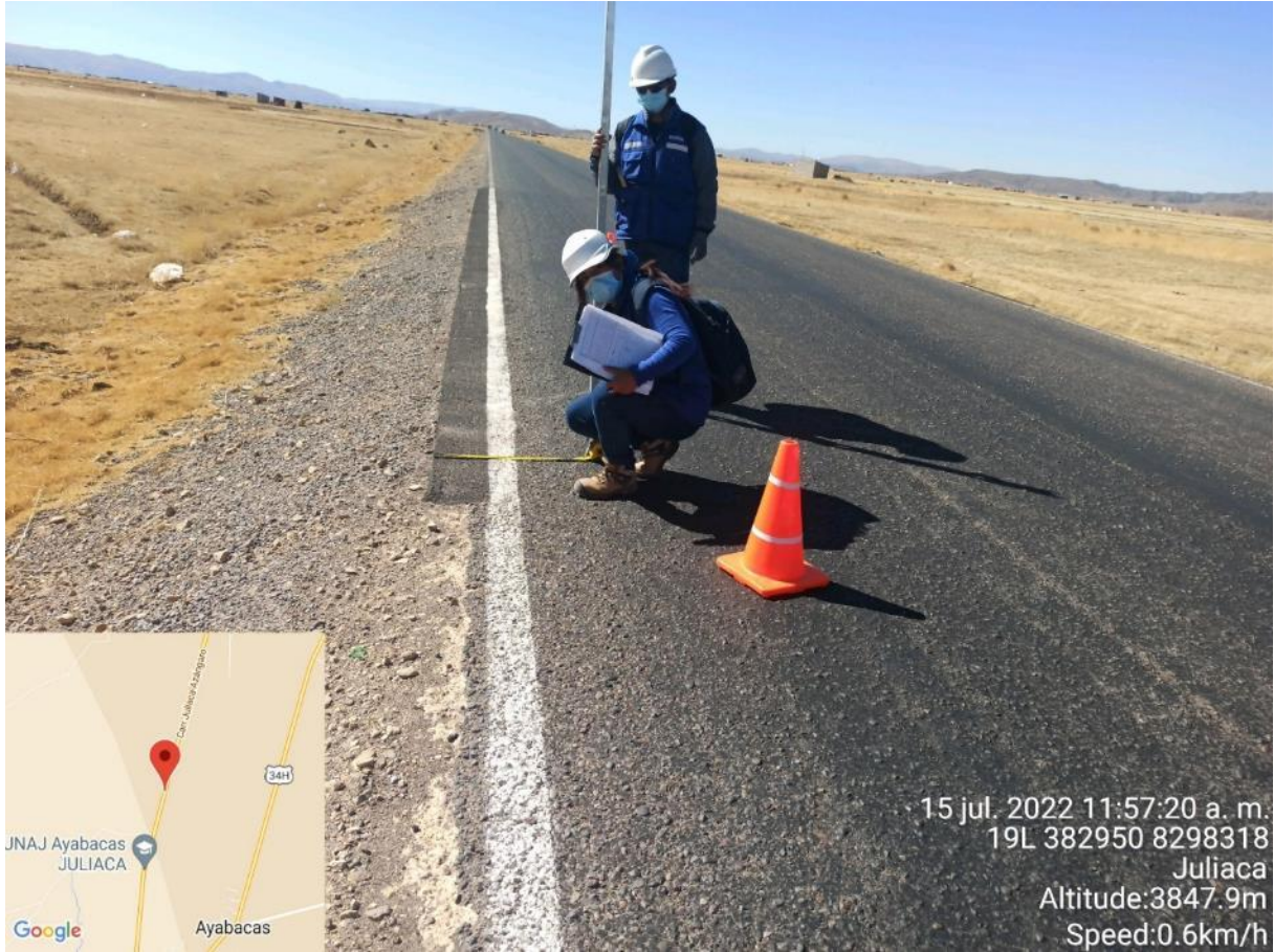
Figura N° 17: Representación gráfica de la falla de “ REPARACIONES O PARCHADOS ”
