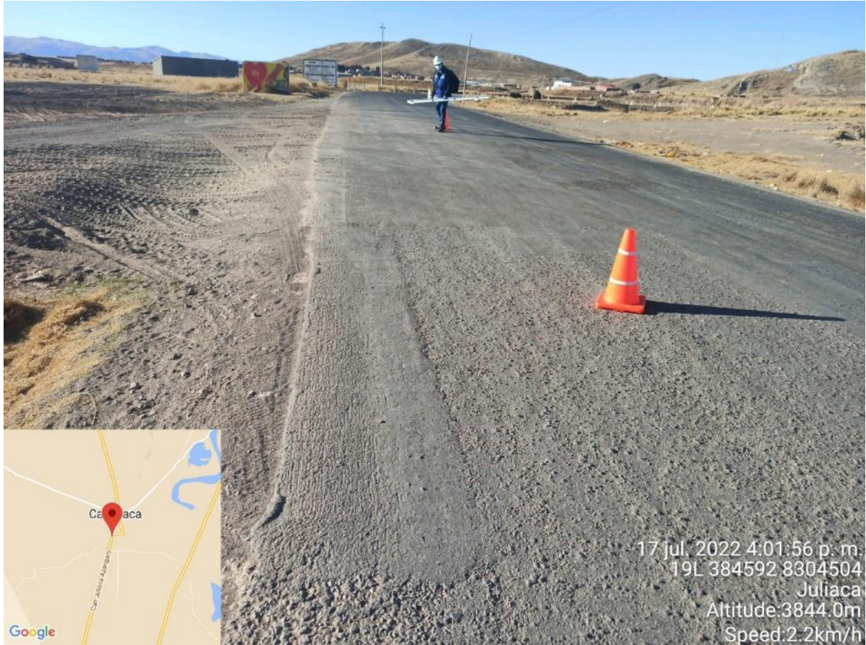
Figura N° 28: Representación gráfica de la falla de “ LIMPIEZA (carácter berma) ” Fuente: Elaboración nuestra
