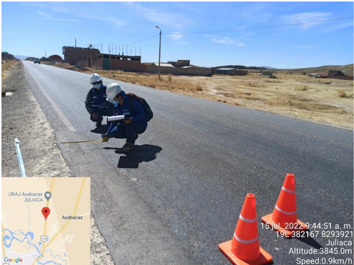
Figura N° 09: Representación gráfica de la falla de “ REPARACIONES O PARCHADOS ”
