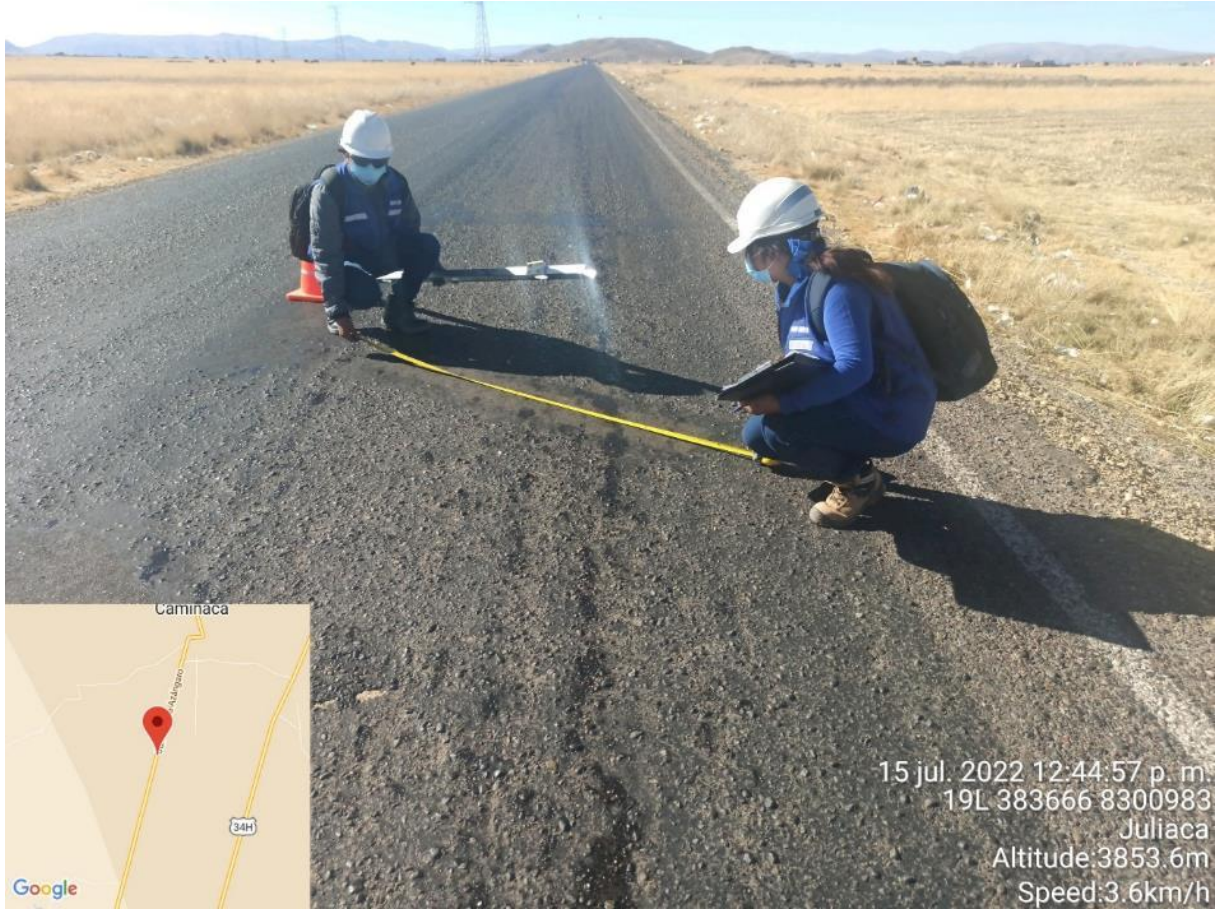
Figura N° 20: Representación gráfica de la falla de “ REPARACIONES O PARCHADOS ” Fuente: Elaboración nuestra
