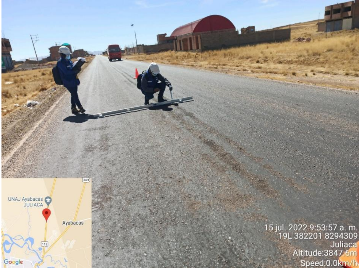
Figura N° 11: Representación gráfica de la falla de “DEFORMACIÓN POR DEFICIENCIA ESTRUCTURAL”
