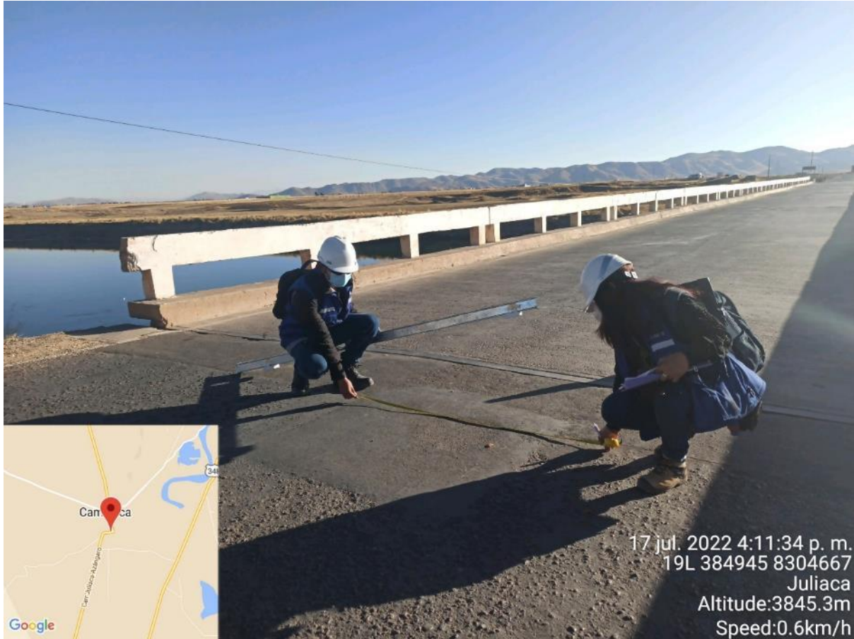
Figura N° 25: Representación gráfica de la falla de “ REPARACIONES O PARCHADOS ”
