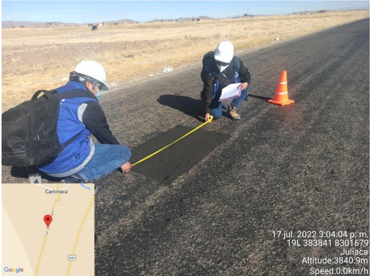
Figura N° 21: Representación gráfica de la falla de “ REPARACIONES O PARCHADOS ”
