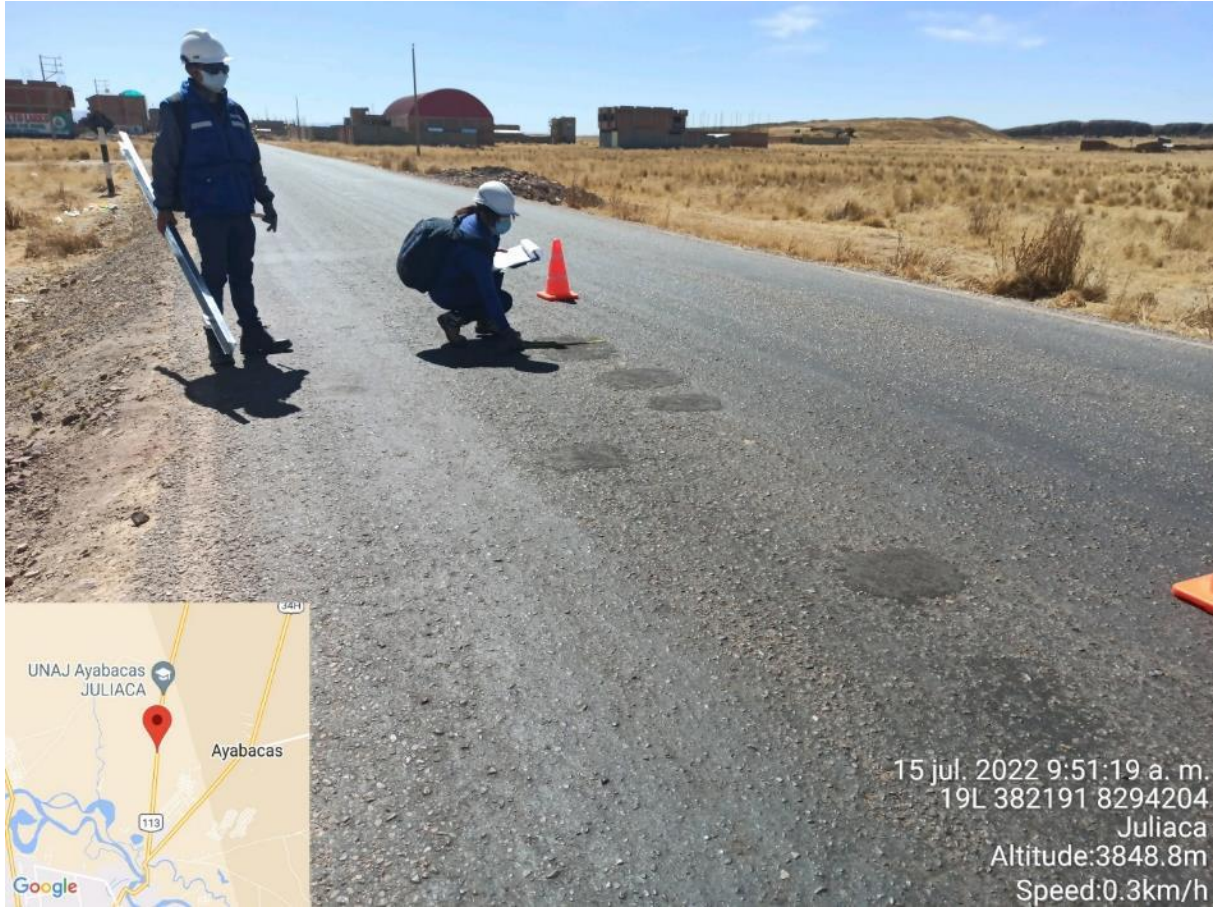
Figura N° 10: Representación gráfica de la falla de “ REPARACIONES O PARCHADOS ”
