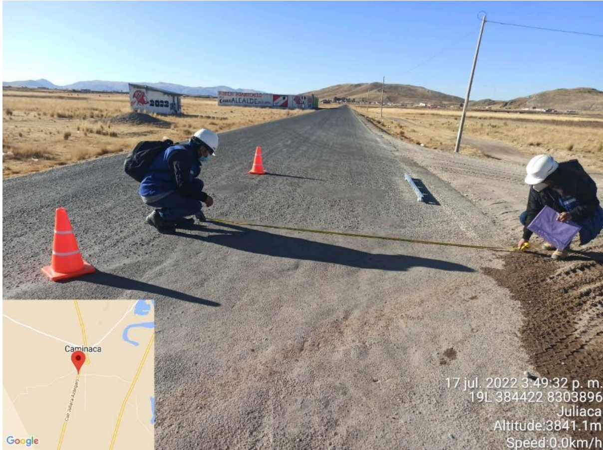
Figura N° 24: Representación gráfica de la falla de “ REPARACIONES O PARCHADOS ”
