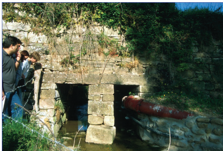
Figura 4. Obras de drenaje transversal en el Real Camino a su paso por Molledo (MRB).
