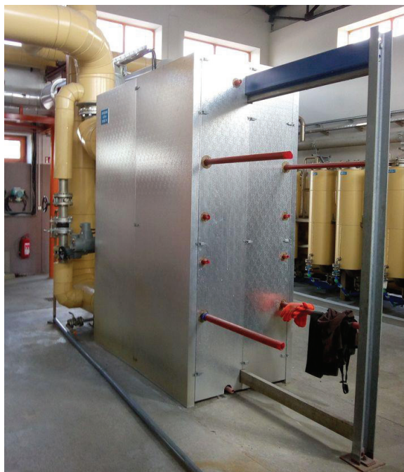
Rycina 45. Płaskie wymienniki ciepła w Geotermii Stargard (fot. B. Iglński)
