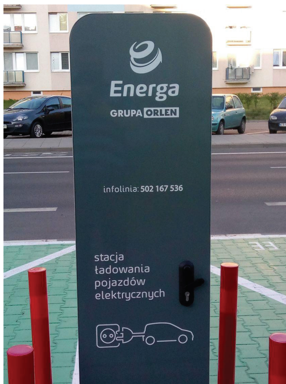
Rycina 53. Stacja ładowania pojazdów elektrycznych w Toruniu (fot. B. Igliński)
