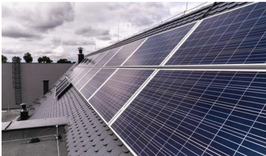
Rycina 36. Fotowoltaika na dachu szkoły w Żukowie (fot. ABB) [101]
