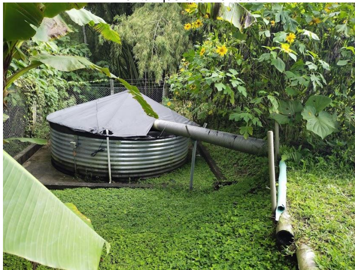
Tanque de almacenamiento tipo australiano, circular removible de lamina. Contiene bomba lapicero
