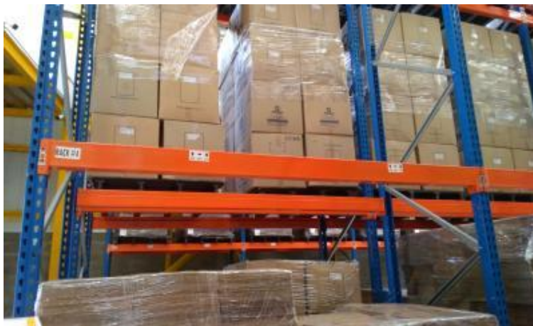
Figuras 14. Estructuras Estanterías (Racks).
