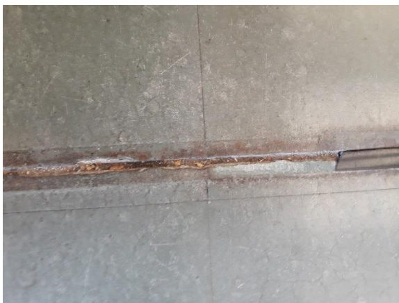
Foto n.º 4 - Junta de Dilatação danificada
