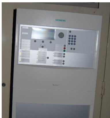
Figura 79 – Central de Incêndios
