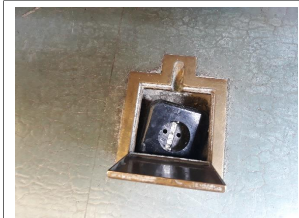
Foto n.º 3 - Tomada danificada
