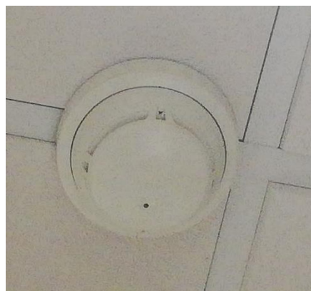
Figura 80 – Detetores de Incêndio
