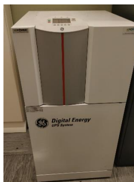
Figura 85 – UPS dos servidores
