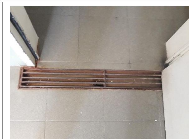
Foto n.º 9 - Corrosão em grelha de pavimento
