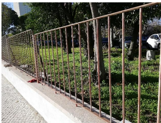
Figura 93 – Corrosão de Gradeamento Exterior
