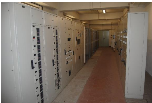
Figura 74 – Quadro Elétrico Geral
