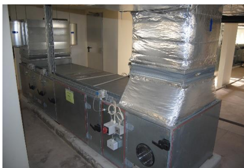
Figura 73 – Sistema de Aquecimento
