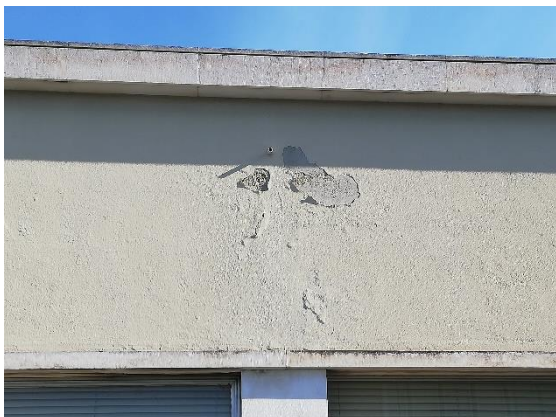
Figura 89 – Destacamento da Pintura
