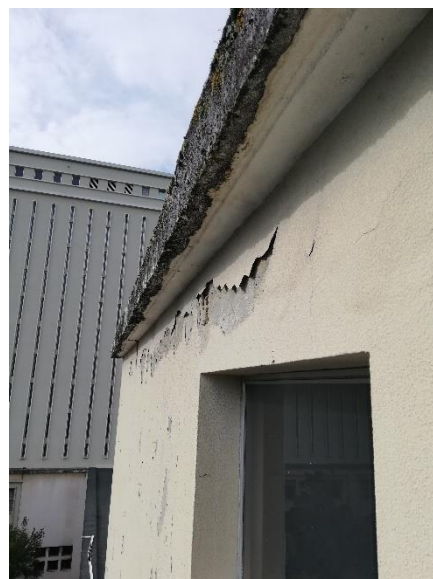
Figura 92 – Destacamento da Pintura
