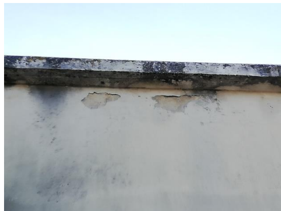
Figura 90 - Destacamento da pintura 15/05/2021
