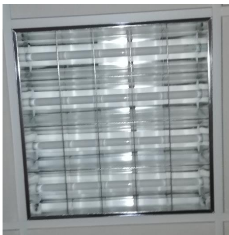
Figura 98 – Armaduras de Iluminação de Gabinetes
