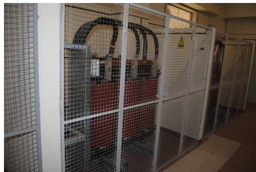
Figura 75 – Posto de Transformação
