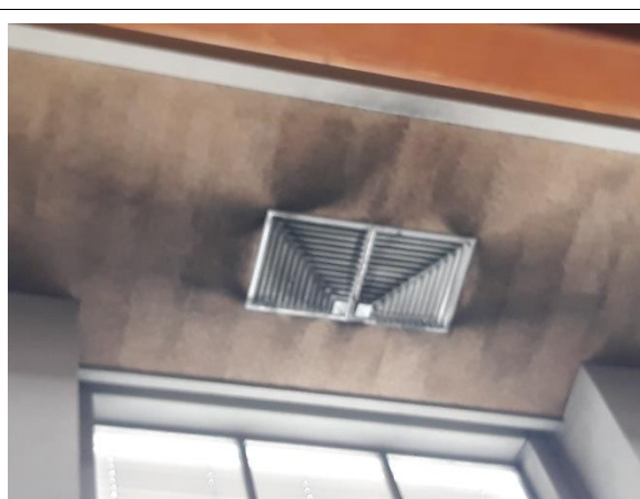
Foto n.º 8 - Falta de limpeza de condutas de Ventilação
