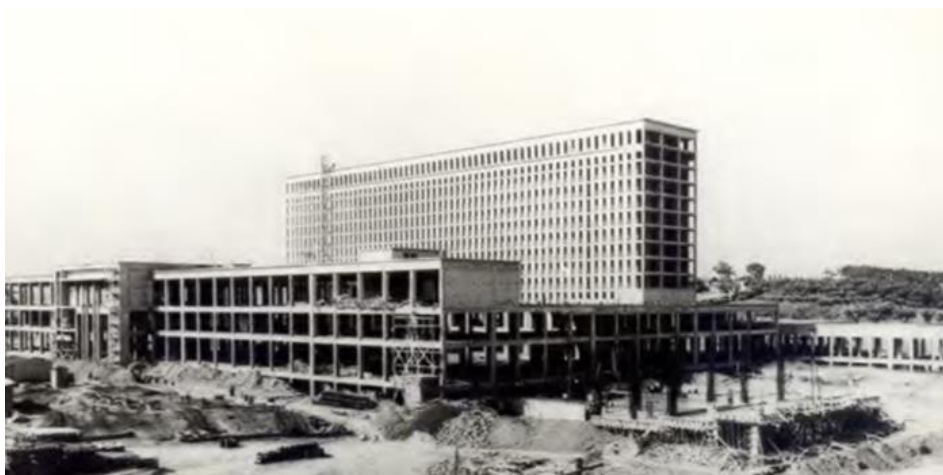
Figura 27 - Vista Geral com a estrutura construída, em fase de execução de alvenarias. Foto do arquivo do Forte de Sacavém do SIPA (IHRU).
