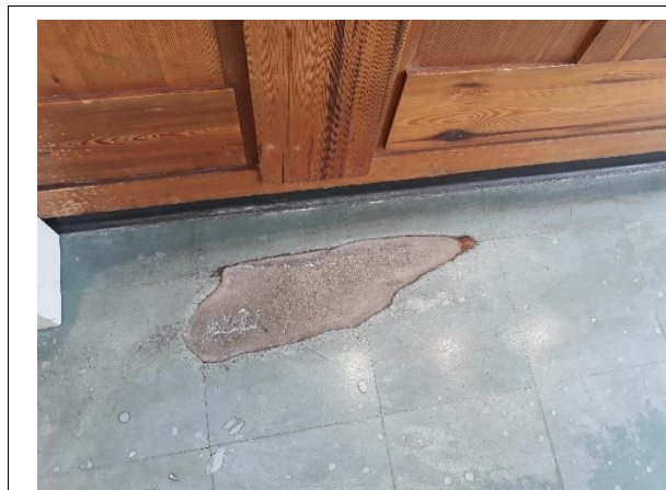
Foto n.º 1 - Pavimento danificado
