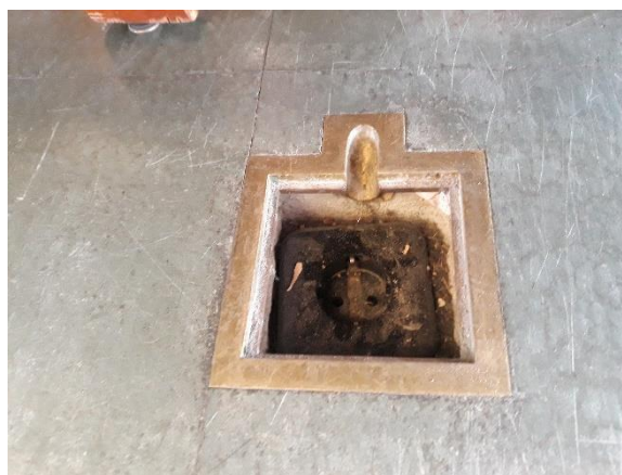
Foto n.º 2 - Tomada com corrosão
