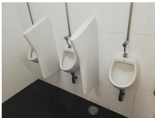
Figura 63 – Louças em Instalações Sanitárias
