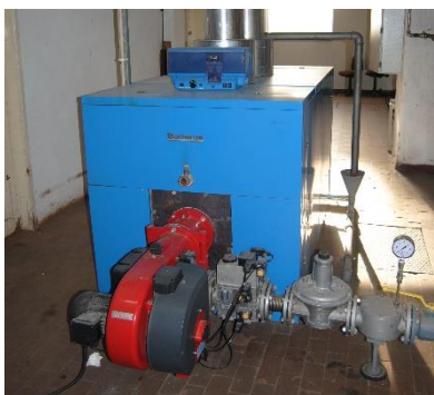
Figura 71 – Caldeira a Gás
