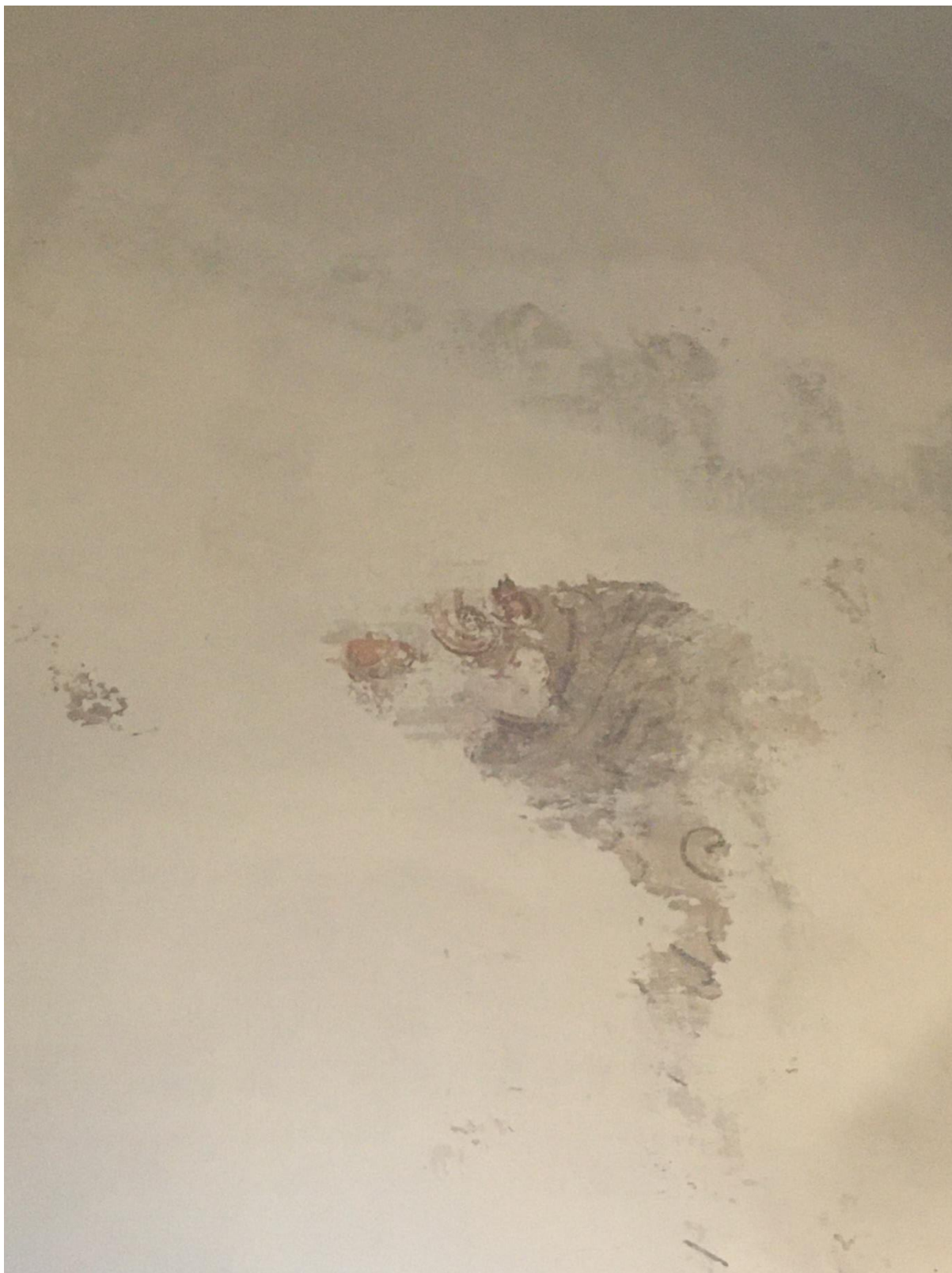
Anexo 31 - Indício de pintura mural no coro-alto da Igreja dos Lóios; Leonor Nogueira, 2022;
