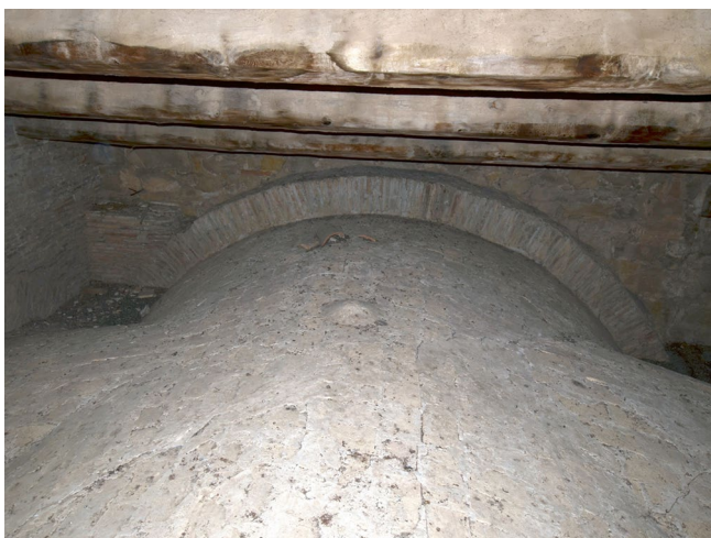
Figura 9. Extradós bóveda [VR1] encuentro arco fajón y formero.
