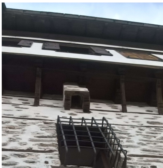
115. Αρχοντικό Γκλαβάνη, νοτιοδυτική όψη. Διακρίνεται η καταχύστρα αξονικά και πάνω από τη θύρα εισόδου στο δάπεδο του τελευταίου ορόφου.
