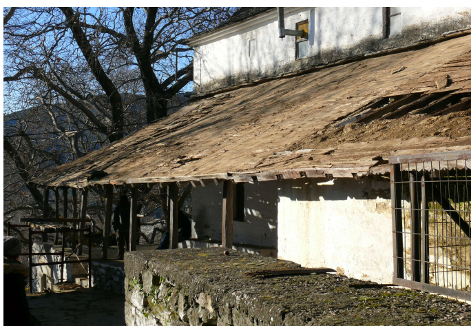
74. Άποψη της εξωτερικής ξύλινης στοάς. Διακρίνεται η σημαντική φθορά που έχει υποστεί η μονόριχτη στέγη.
