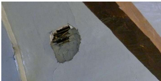
60. Κατεστραμμένο τμήμα στη θολοδομία της οροφής επιβεβαιώνει την κατασκευή της από μπαγδατί.
