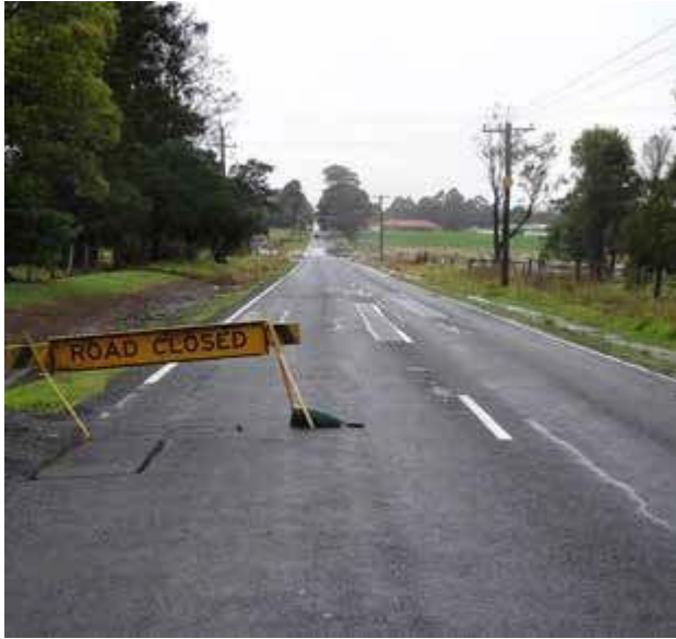
Εικόνα 48: Οδόφραγμα σε πλημμύρα, Πηγή: Andrew Gissing et al, 2015
