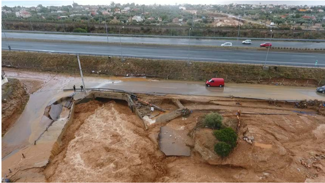
Εικόνα 5: Φθορές στο οδικό δίκτυο μετά την καταστροφή Πηγή: (Efthymios Lekkas, 2017)
