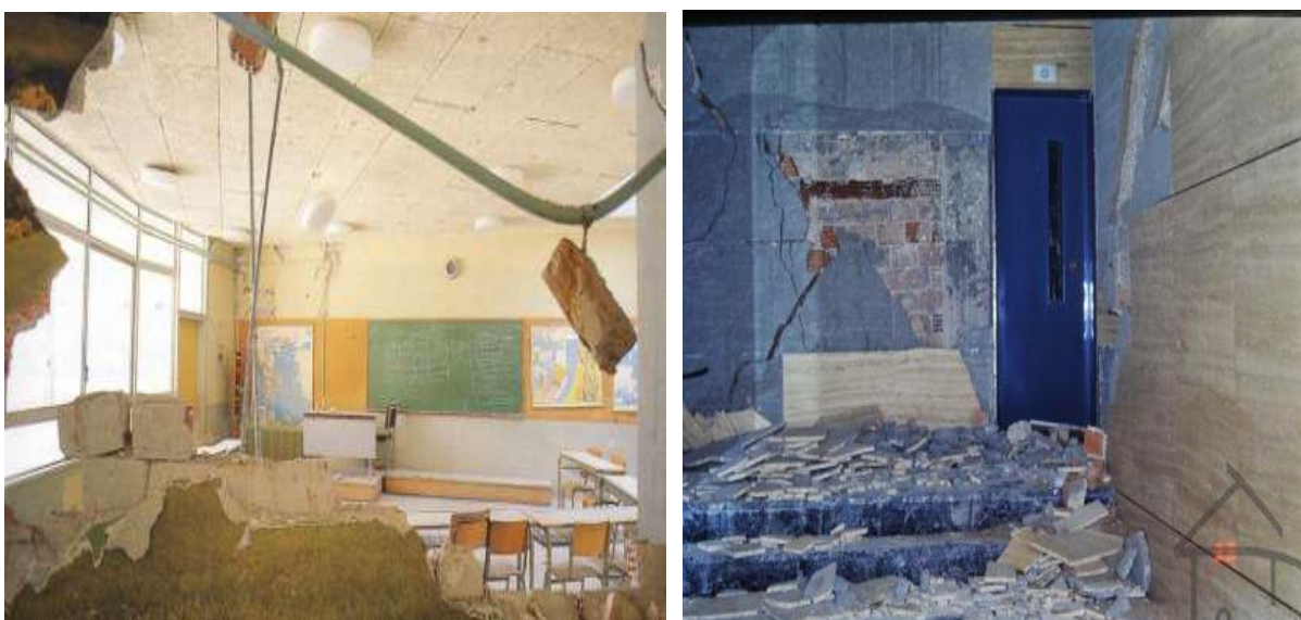
Εικόνα 3-4. Εσωτερικό σχολικής αίθουσας (αριστερά) και είσοδος πολυκατοικίας (δεξιά) μετά το σεισμό της Καλαμάτας, 1986
