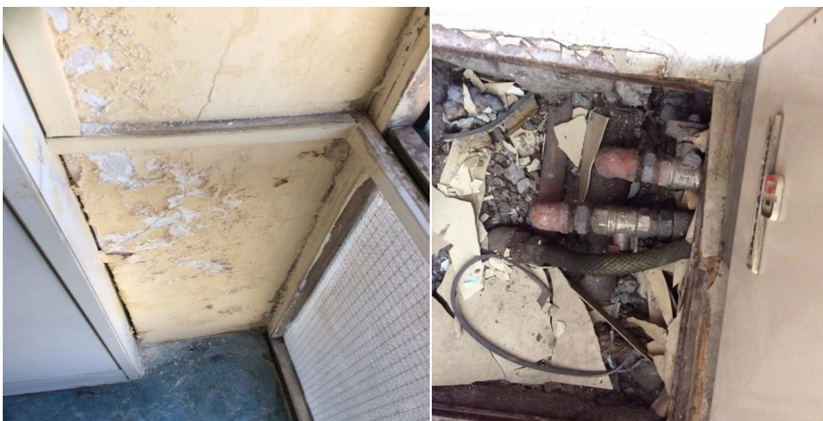
Εικόνα 4-6. Υγρασίες σε υποστύλωμα, οφειλόμενες πιθανά στο υποδαπέδιο δίκτυο θέρμανσης
