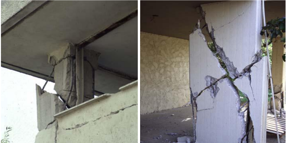
Εικόνα 3-3. Αστοχία κοντού υποστυλώματος και διατμητική αστοχία υποστυλώματος με μεγάλες παραμορφώσεις
