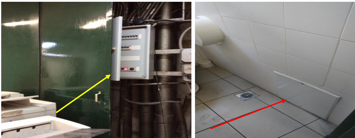
Εικόνα 4-4. Θέσεις γενικού ηλεκτρικού διακόπτη ορόφου και βάνας παροχής ύδρευσης
