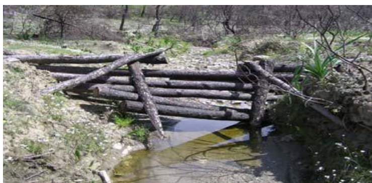
Εικόνα 32. Καταστροφή κορμοφράγματος λόγω κακής θεμελίωσης (Πηγή: Μάρης και Θεοφάνους, 2008).
