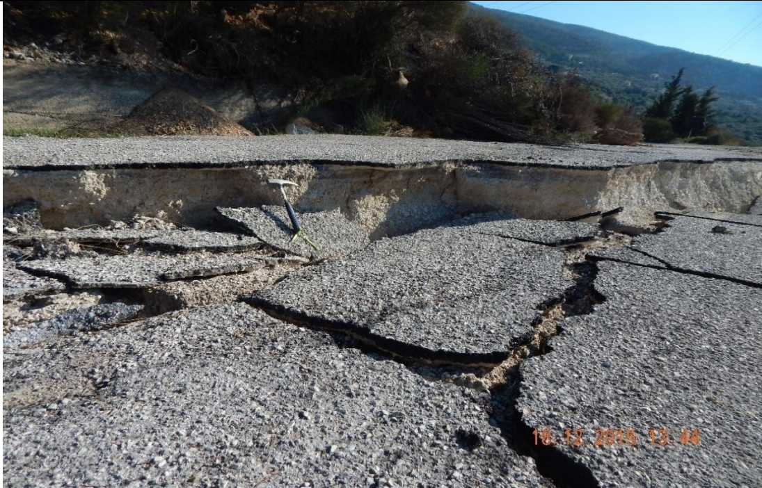
Αποτελέσματα του σεισμού της Τρίτης 17 Νοεμβρίου 2015: Εκτεταμένες ζημιές στο επαρχιακό οδικό δίκτυο στην περιοχή Δ του Αθάνιου.
