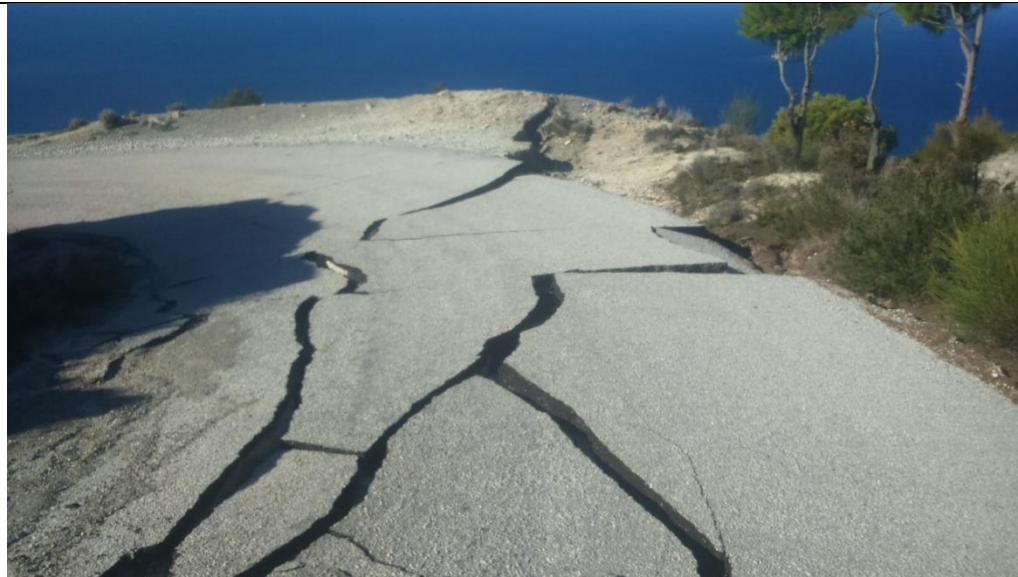
Αποτελέσματα του σεισμού της Τρίτης 17 Νοεμβρίου 2015 (Συνέχεια): Σε ορισμένα σημεία ο δρόμος κατέστη σχεδόν απροσπέλαστος.
