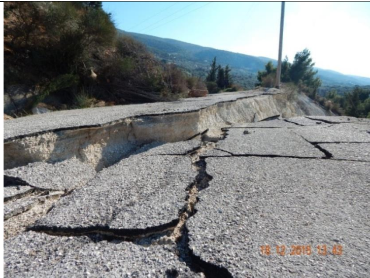
Ρωγμές στο επαρχιακό οδικό δίκτυο αποτέλεσμα του σεισμού Τρίτης 17 Νοεμβρίου 2015.
