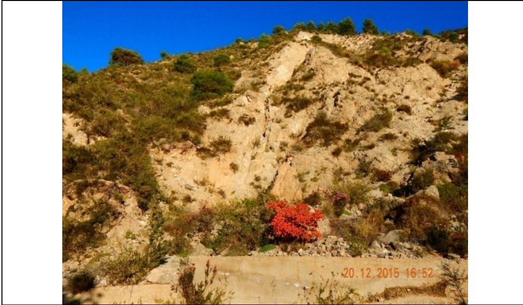
Κατολισθήσεις του πρανούς κατά μήκος του πρανούς του δρόμου
