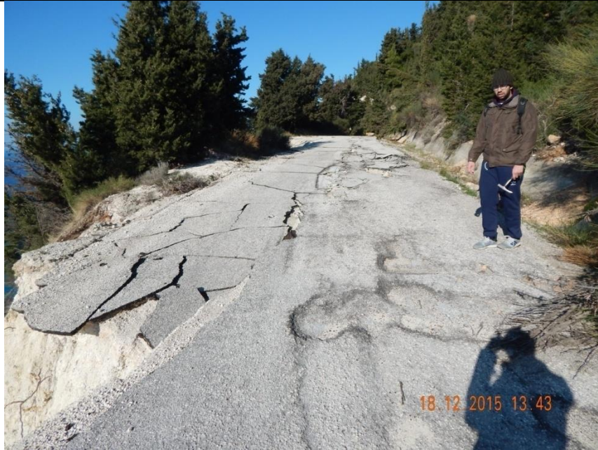
Αποτελέσματα του σεισμού της Τρίτης 17 Νοεμβρίου 2015 (Συνέχεια): Περισσότερες ρωγμές στο δρόμο του Αθανίου
