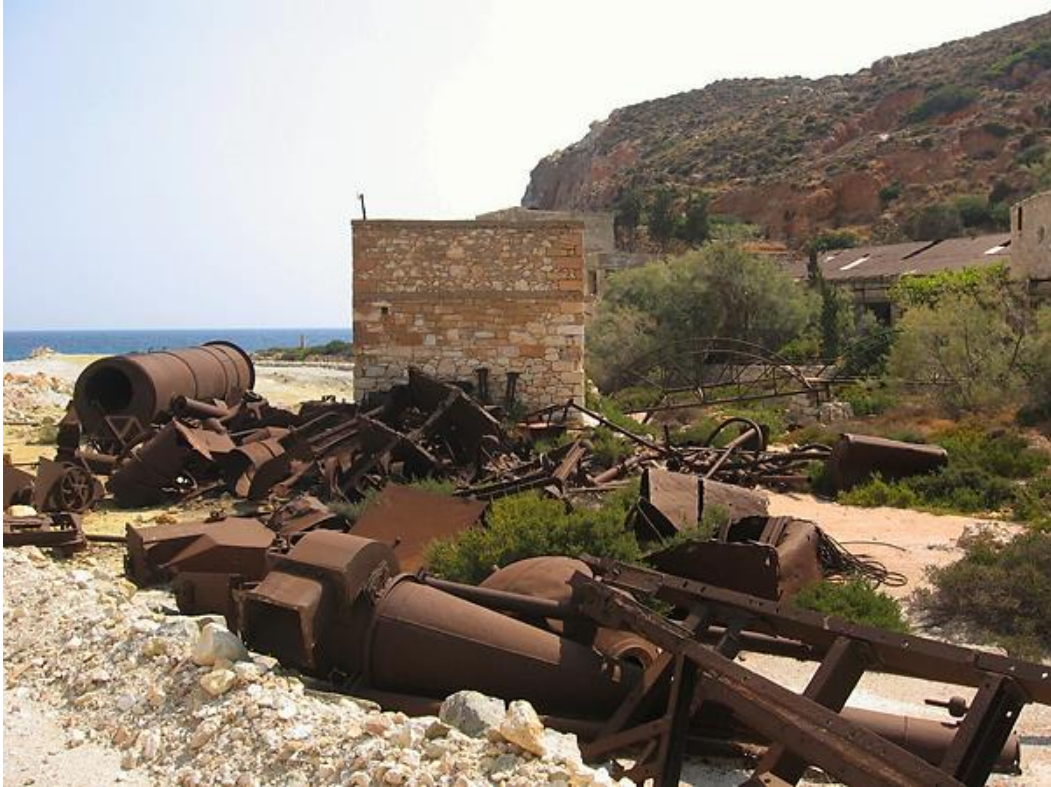
Εικόνα 53: Εξαρτήματα του μηχανολογικού εξοπλισμού με εμφανή τα ίχνη της διάβρωσης, μπροστά από το Σχεδιαστήριο, φωτ. προσωπικό αρχείο γράφουσας.
