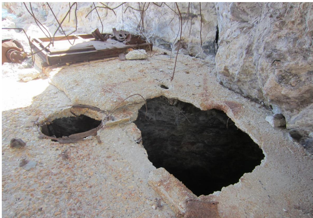
Εικόνα 52: Σκουριασμένα μεταλλικά τμήματα των μηχανολογικών εγκαταστάσεων και ίχνη από πηγάδια και υπόγειες δεξαμενές για την τροφοδοσία του συγκροτήματος με νερό, κοντά στην προβλήτα φόρτωσης του μεταλλεύματος, φωτ. προσωπικό αρχείου γράφουσα.
