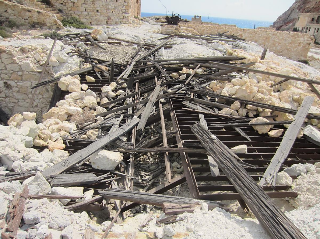
Εικόνα 54: Διασκορπισμένα ξύλινα και μεταλλικά στοιχεία από την καταστροφή και κατάρρευση της στέγης και του μηχανολογικού εξοπλισμού του εργοστασίου, φωτ. προσωπικό αρχείο γράφουσας.
