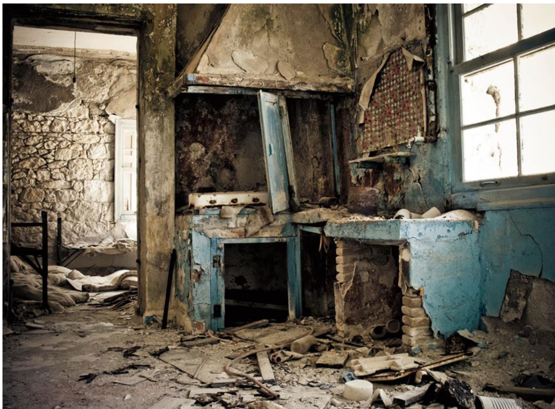
Εικόνα 47: Φούρνος και μαγειρείο που σώζονται στις κατοικίες του προσωπικού των Θειωρυχείων, πηγή: www.totallylost.eu .
