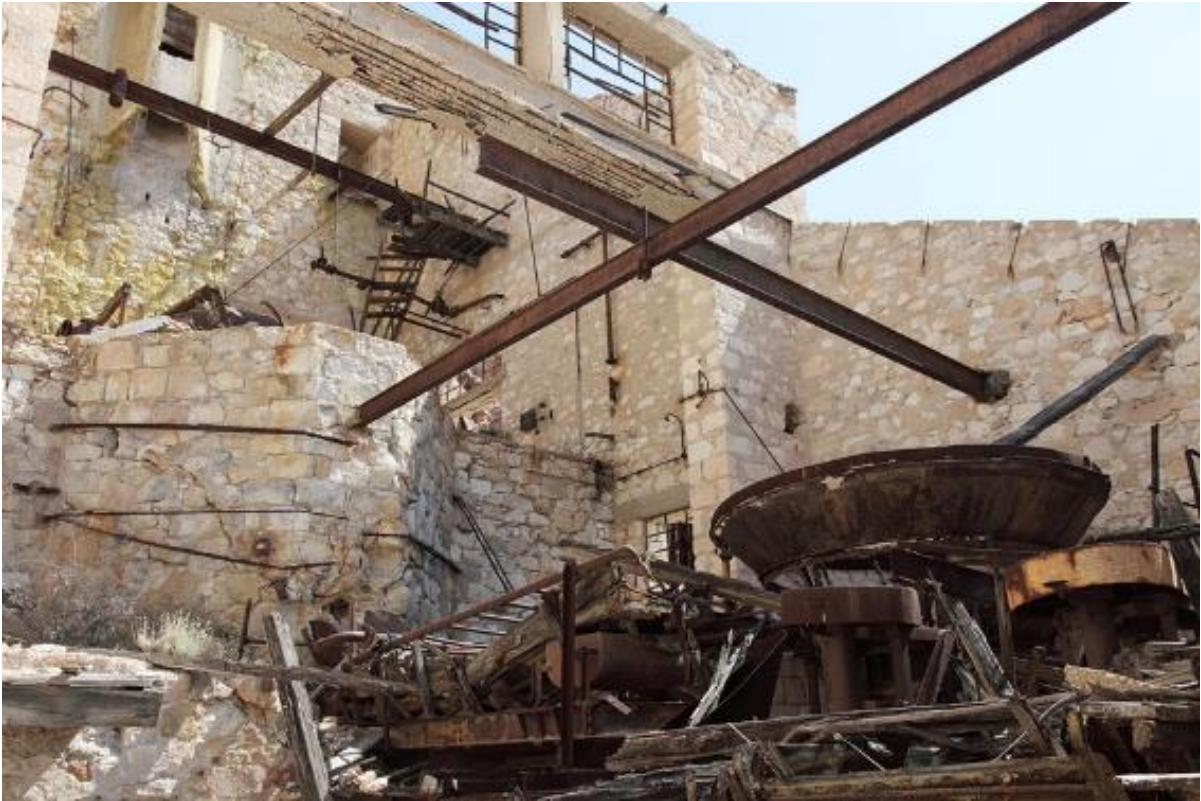
Εικόνα 30: Εγκατάσταση επίπλευσης του θείου στην βόρεια ενότητα του συγκροτήματος, φωτ. προσωπικό αρχείο γράφουσας.
