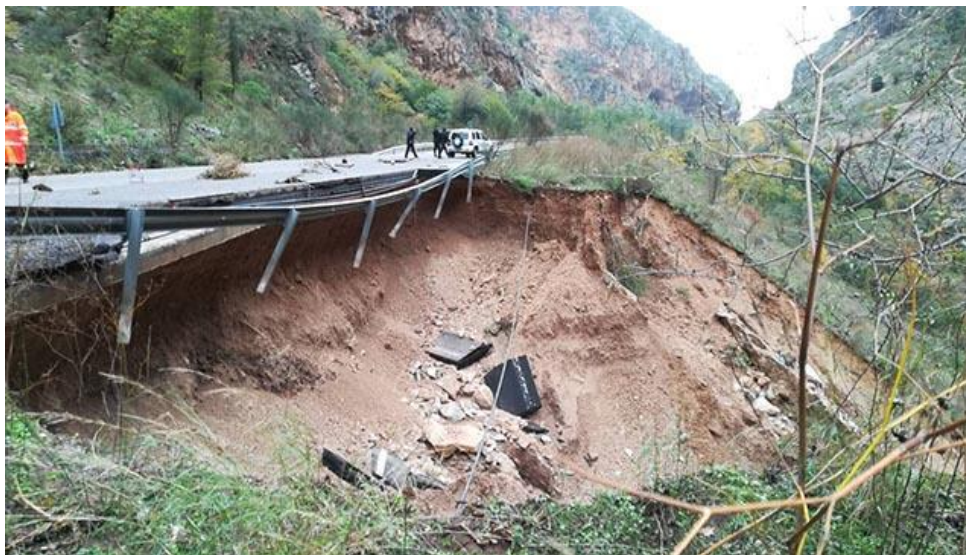
Εικόνα 6-2. Υποσκαφή και κατάρρευση Εθνικής Οδού Αγρινίου-Μεσολογίου.
