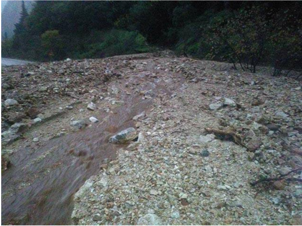
Εικόνα 6-6. Φερτά υλικά επί της Εθνικής Οδού Αग्रινίου-Μεσολογίου.
