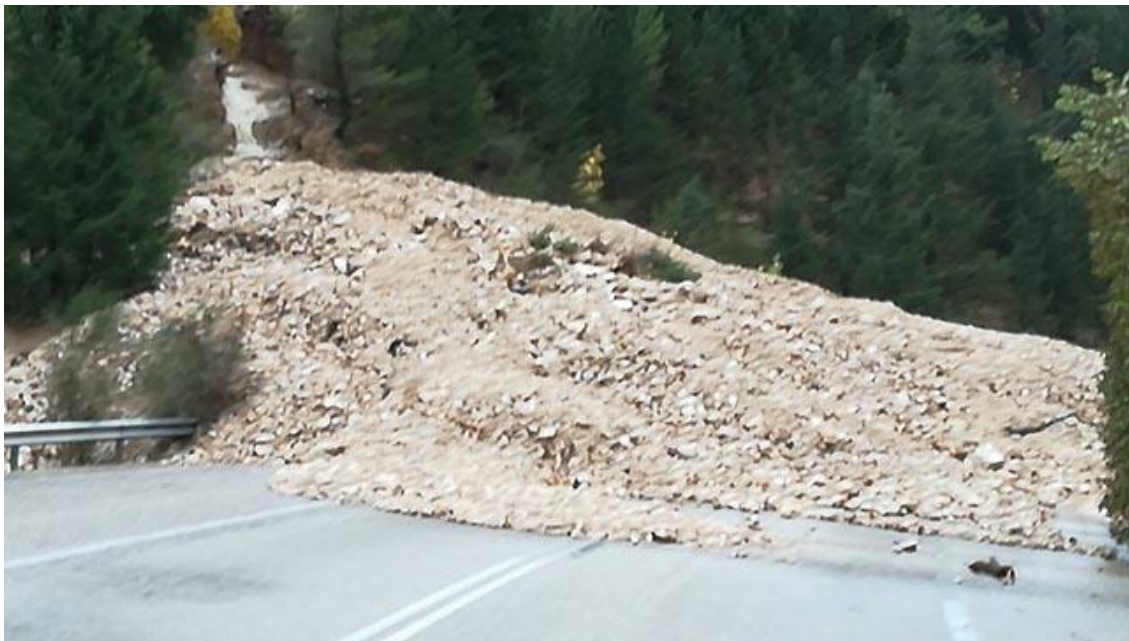
Εικόνα 6-1. Κατολίσθηση επί της Εθνικής Οδού Αγρινίου-Μεσολογγίου.
