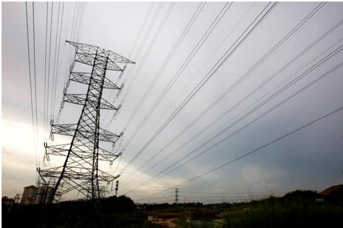
Εικόνα 10: καλώδια υψηλής τάσης της ΔΕΗ
