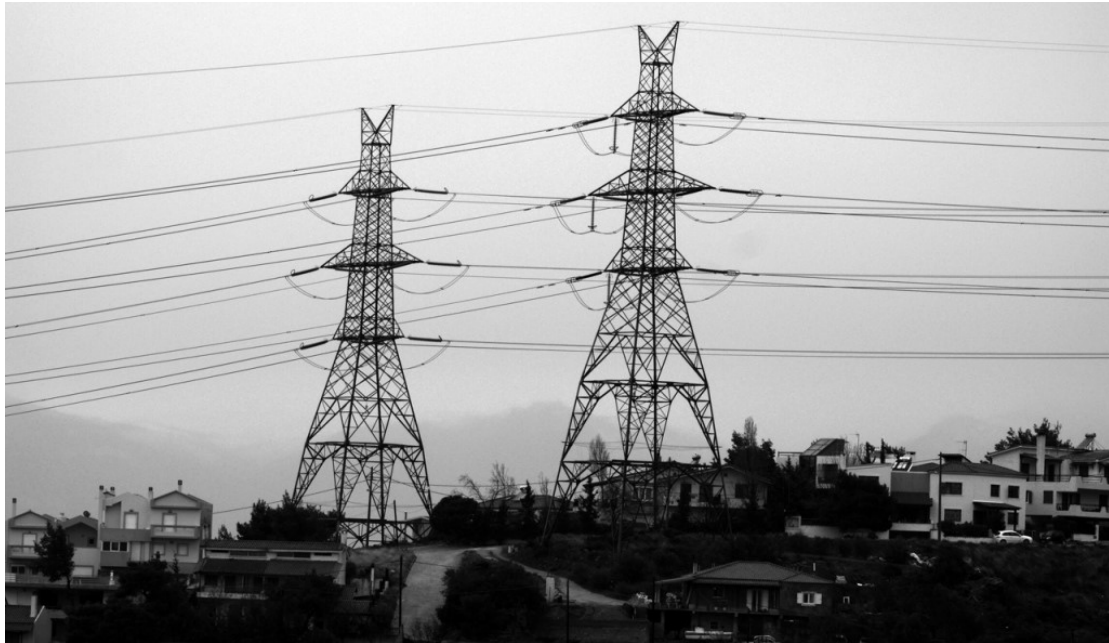
Εικόνα 11: πυλώνες υπερυψηλής τάσης της ΔΕΗ σε κατοικημένη περιοχή
