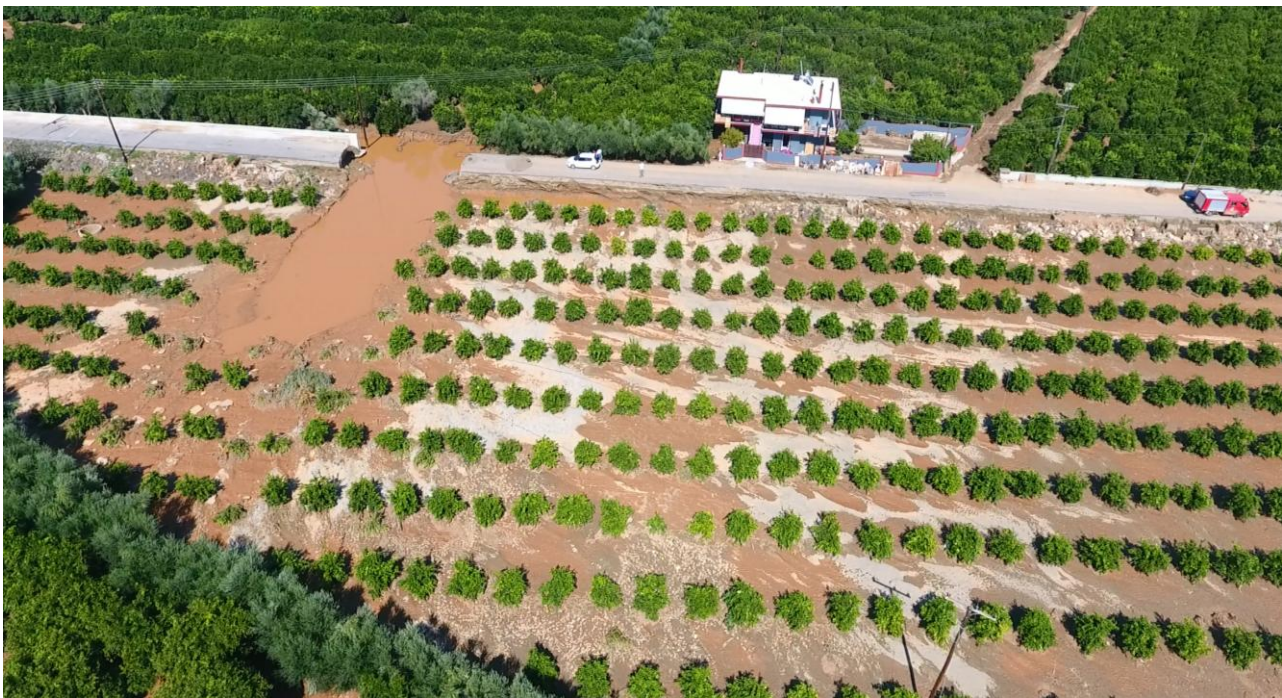
Εικόνα 1.2.4: Αστοχία αντιπλημμυρικού αναχώματος ανατολικά του Ευρώτα κατά τις πλημμύρες του Σεπτεμβρίου 2016 (περιοχή Ταξιάρχες).
