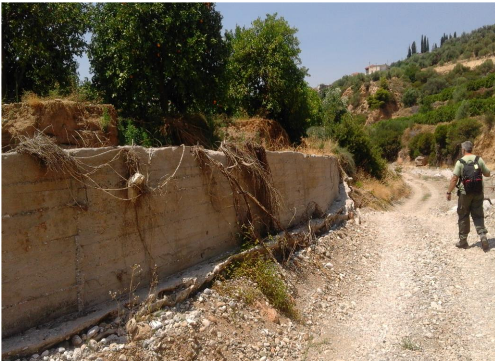
Εικόνα 2.2.1.2:Επιτόπια έρευνα και λήψη φωτογραφικού υλικού . Πάνω η κοίτη του Μαριορέματοςκαλυμμένη με αδρομερή υλικά από την πλημμύρα, και η δεξιά αναβαθμίδα με λεπτομερείς αποθέσεις στην είσοδο του μαιάνδρου. Κάτω: αντιδιαβρωτικός τοίχος προστασίας της καλλιέργειας στην αριστερή πλευρά της κοίτης ανάντι του μαιάνδρου.
